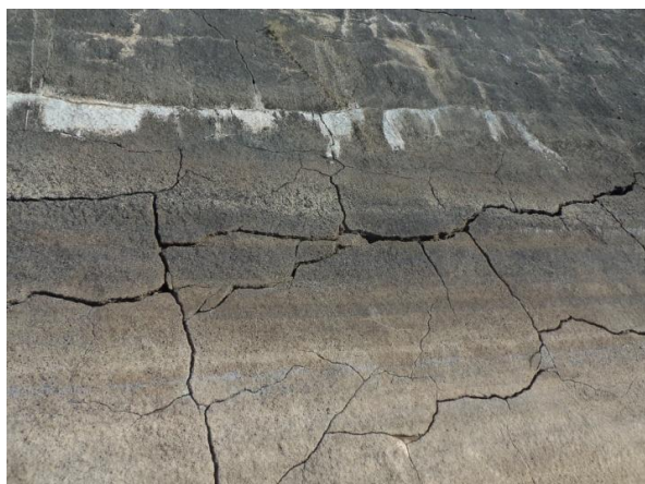
Figura 1: Patrón de fisuración tipo “piel de cocodrilo” encontrado en los terraplenes
