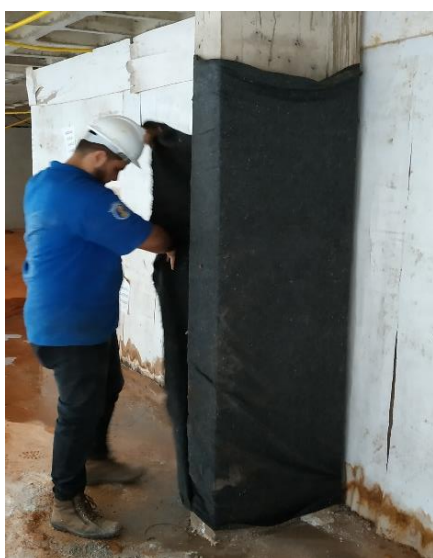
Figura 6: Umedecimento da Estrutura de Concreto
