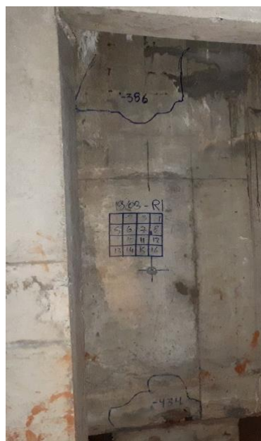
Figura 2 – Pontos de alta probabilidade de corrosão no Reservatório
