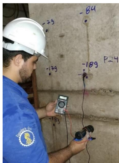
Figura 7: END de Potência de Corrosão
