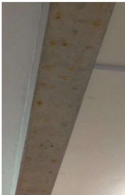
Figura 2. Corrosão de estribos em vigas.
