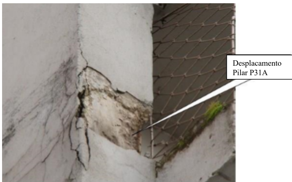
Figura 11. Deslocamento do pilar.
