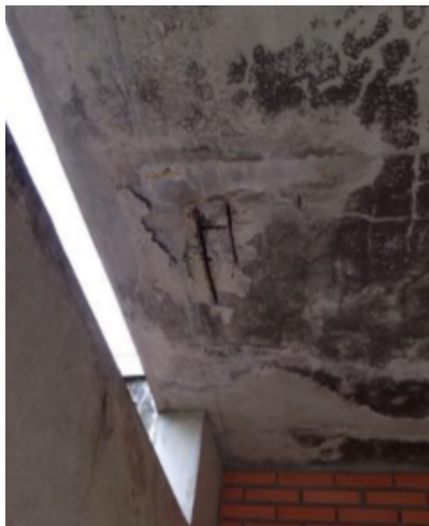
Figura 4. Infiltração em laje.
