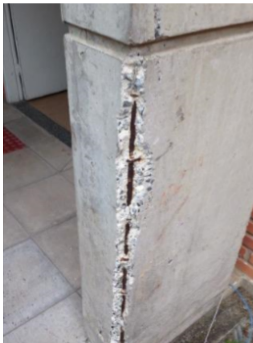
Figura 7: Deslocamento do concreto num pilar.
