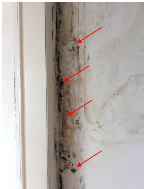
Figura 3: Bolor e manchas de umidade (LIMA, 2015).
