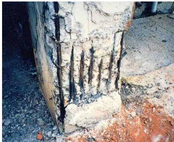
Figura 4: Corrosão de armaduras em um pilar (HELENE, 1993).
