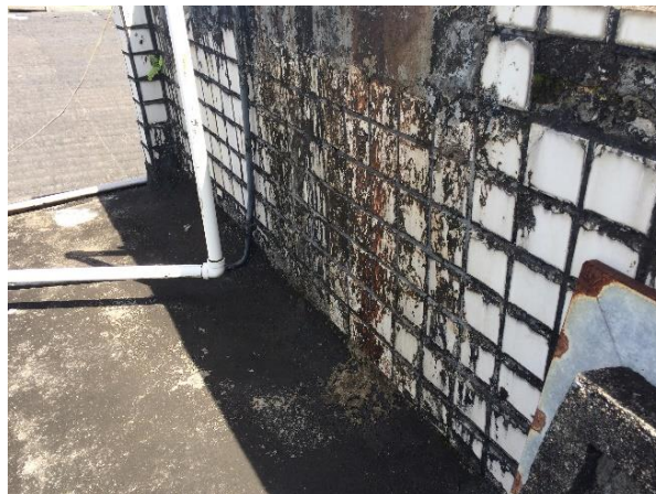
Figura 12: Bolor em parede da caixa d'água.
