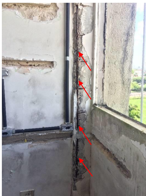
Figura 13: Corrosão aparente em pilar da fachada.
