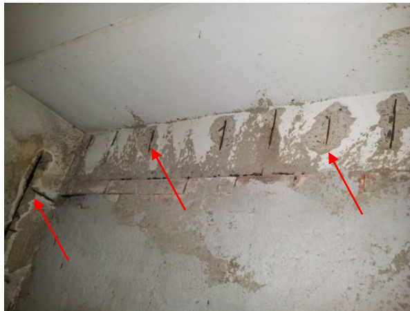
Figura 8: Pilar e viga com corrosão aparente (UFPE, 2012).
