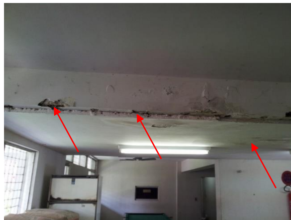
Figura 9: Manchas de corrosão, fissuras e corrosão aparente (UFPE, 2012).
