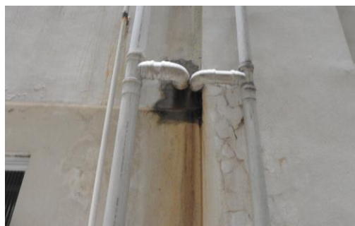
Figura 82 - Vazamento em tubulação de água fria (poço de luz). Fonte: Autor: Ágatha Canellas.
