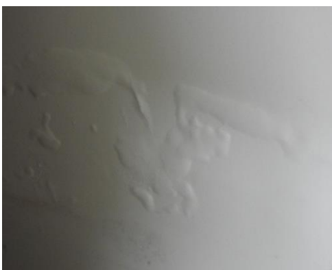
Figura 4 - Bolhas na pintura por infiltração (apartamento 10° pav.). Fonte: Autor: Ágatha Canellas.
