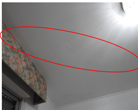
Figura 3 - Fissura na extremidade da laje (apartamento 2º pav.). Fonte: Autor: Ágatha Canellas.
