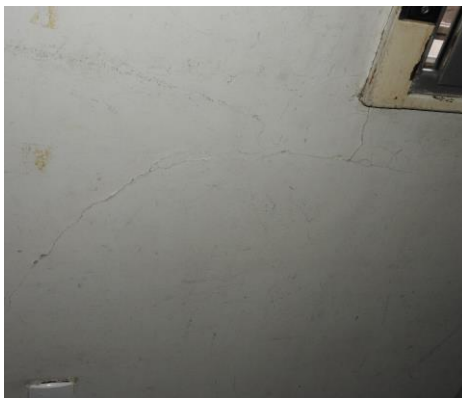
Figura 1 - Fissuras na borda da esquadria (apartamento 12° pav.). Fonte: Autor: Ágatha Canellas.
