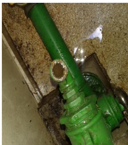
Figura 10 - Incrustação nas tubulações da válvula redutora de pressão (poço de luz). Fonte: Autor: Ágatha Canellas.
