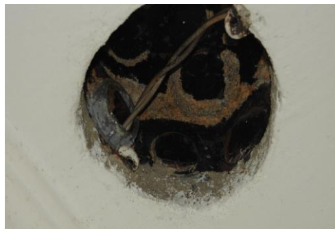
Figura 7 - Eletrodutos oxidados com incrustação (área comum, 2º pav.). Fonte: Autor: Ágatha Canellas.
