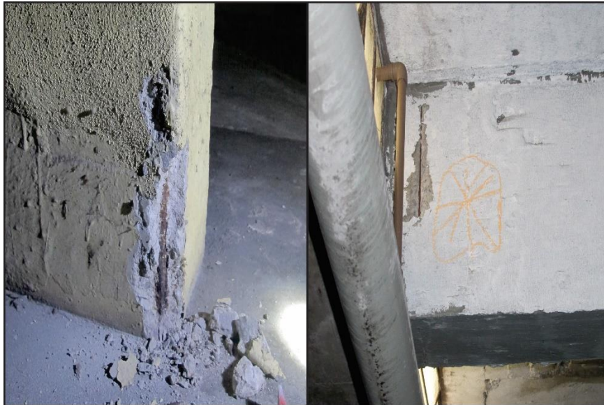
Figura 1 - Corrosão da armadura em pilar e viga (garagem subsolo). Fonte: Autor: Ágatha Canellas.
