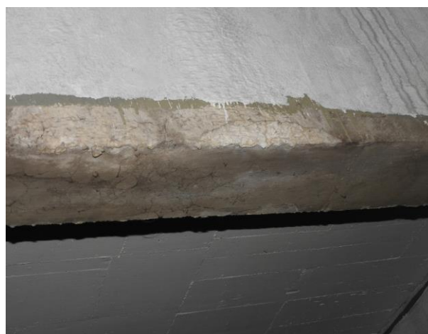
Figura 2 - Lixiviação do concreto (garagem subsolo). Fonte: Autor: Ágatha Canellas.
