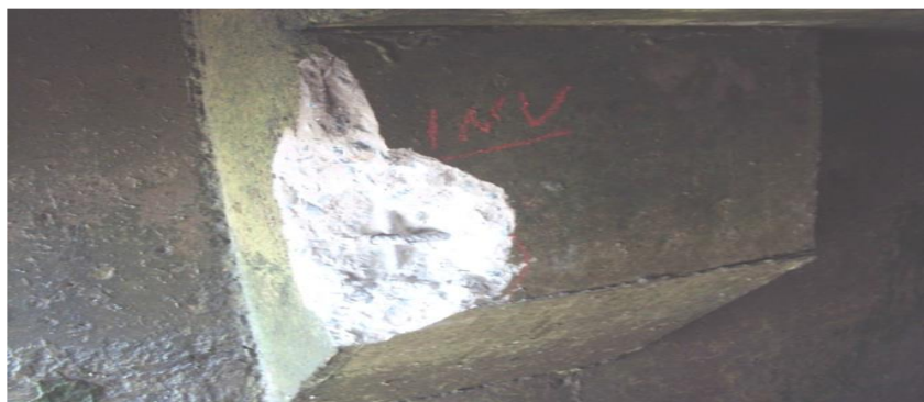
Figura 2: Investigação realizada no elemento console, vão 2.
