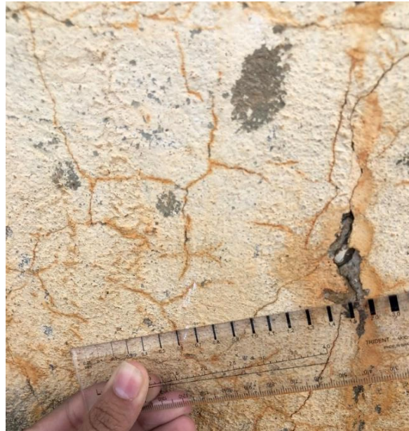
Figura 11: Fissuras mapeadas devido a RAA
