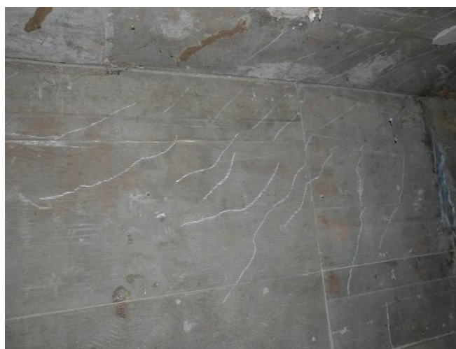
Figura 16: Fissuras inclinadas no interior dos caixões
