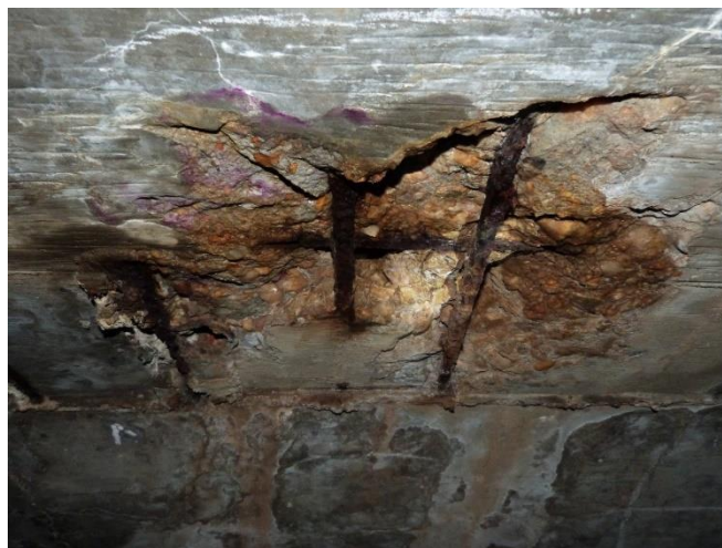
Figura 5: Corrosão das armaduras, Caixaõ P9LD1
