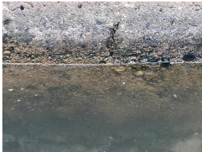
Figura 18: Manifestação de erosão nos pilares, P1
