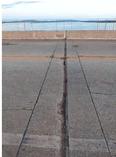
Figura 14: Junta de dilatação desgastada
