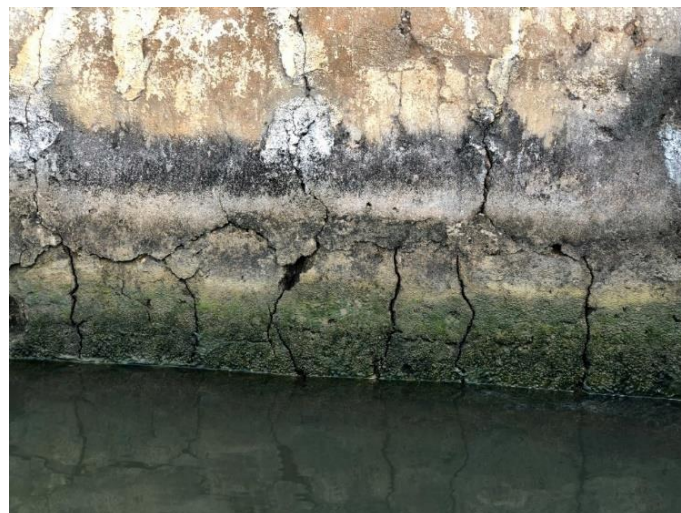
Figura 10: Fissuras espessas devido a RAA
