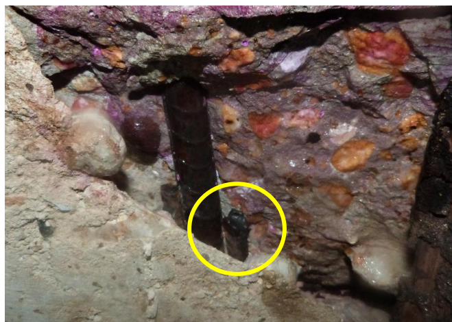
Figura 7: Armadura rompida, Caixa P7LD1
