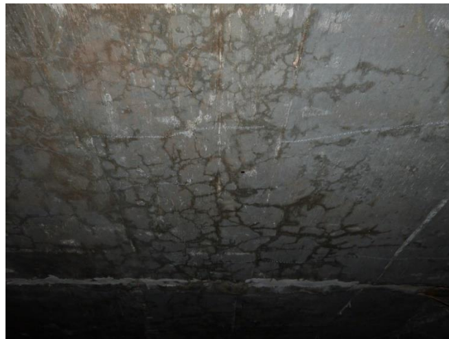
Figura 12: Fissuras mapeadas na face superior dos caixões, Caixão P6LD2
