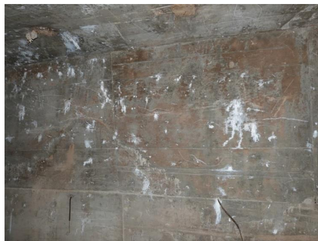
Figura 8: Lixiviação e eflorescência nos caixões
