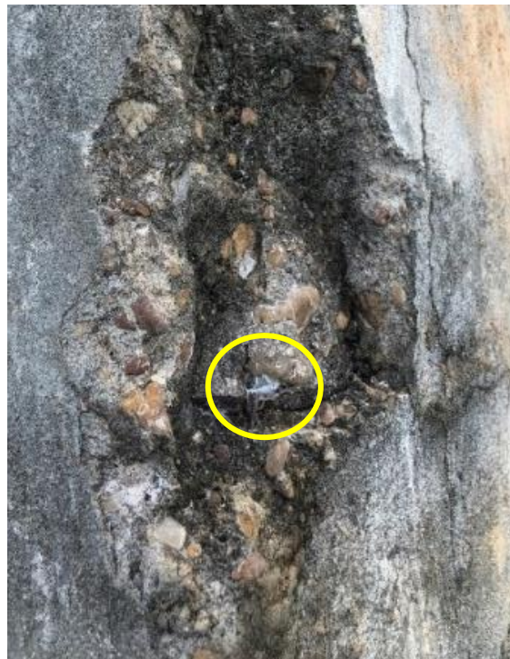
Figura 13: Gel proveniente da RAA ao redor da armadura
