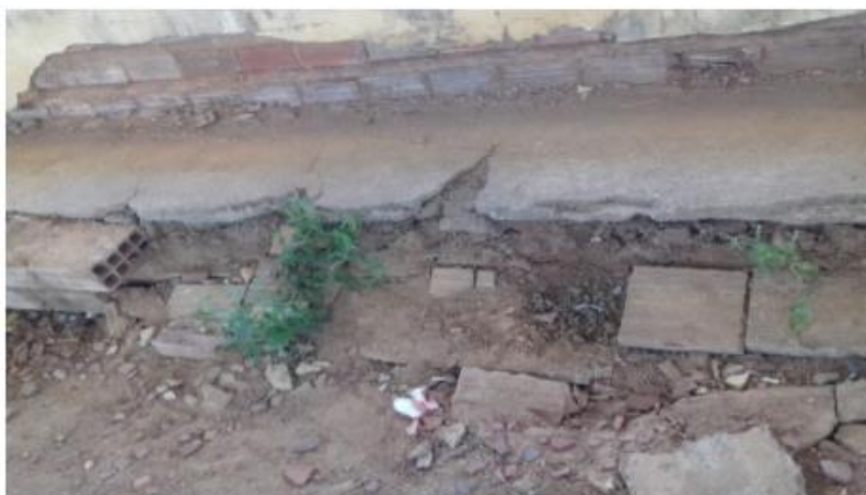
Figura 2 – Piso danificado da arquibancada
