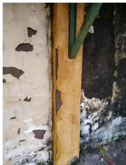
Figura 18 - Desplacamento de revestimento argamassado do pilar
