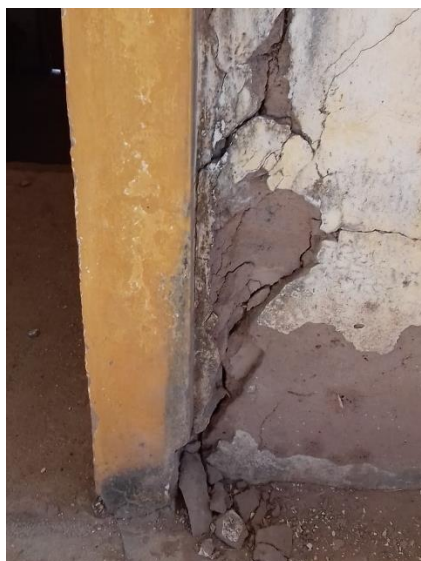
Figura 13 – Fissura na base do pilar da parede Oeste interna
