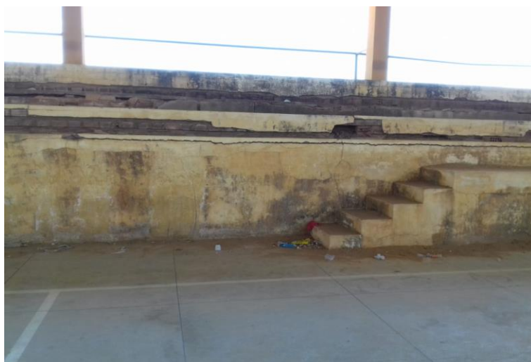
Figura 3 – Fissura na arquibancada
