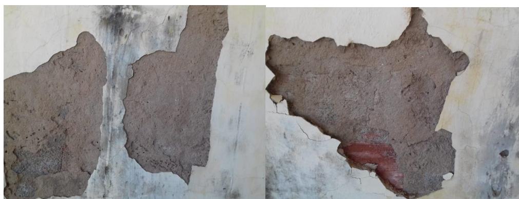
Figura 14– Deslocamento do revestimento argamassado
