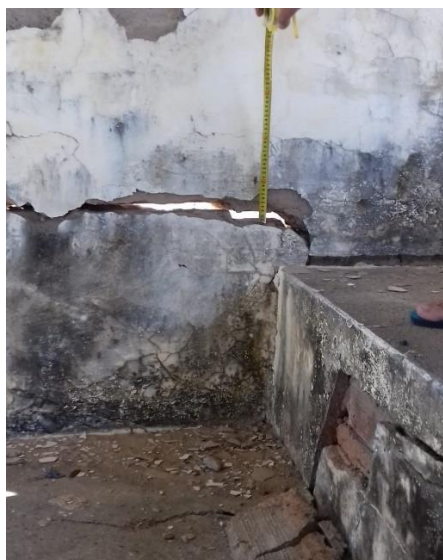
Figura 11 – Abertura na junção da alvenaria Oeste com arquivancada
