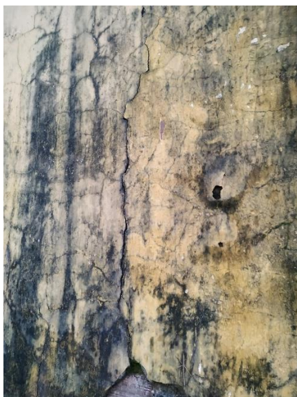
Figura 9 – Manchas de umidade
