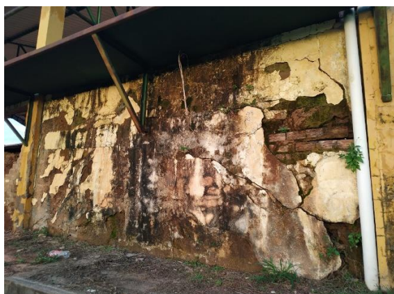
Figura 7 – Desplacimento e fissuras
