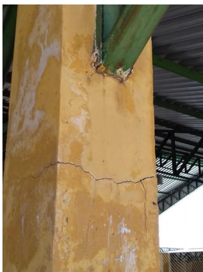
Figura 15 – Fissura, eflorescência e manchas de umidade
