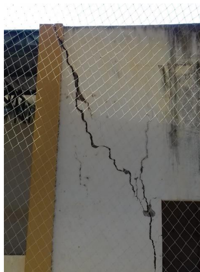
Figura 12 – Fissura parte superior na entrada do vestiário
