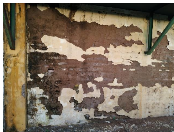
Figura 8 – Desplacimento do revestimento
