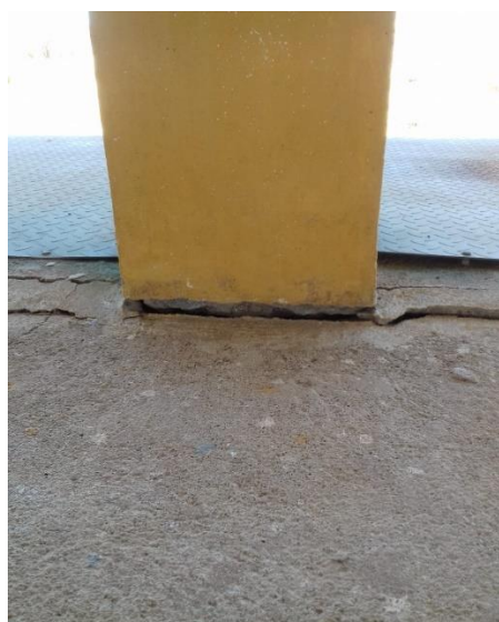
Figura 17 – Recalque da base do piso da arquibancada
