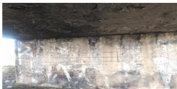
Figura 6 – Armadura exposta no pilar 14
