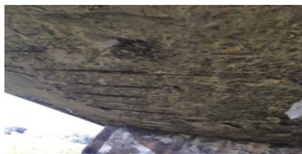
Figura 5 - Armadura exposta, laje entre pilares 13 e 14
