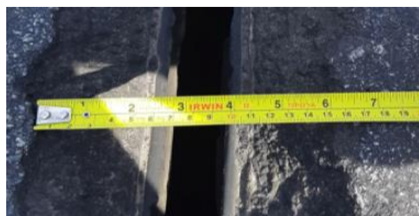
Figura 9 - Falta de manutenção na junta de dilatação
