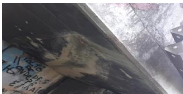
Figura 8 – Falta de drenos adequados
