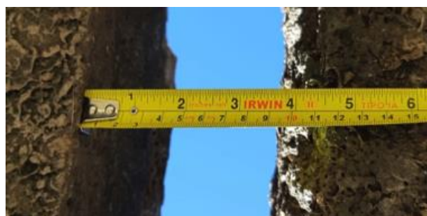
Figura 7 - Falta de manutenção na junta de dilatação
