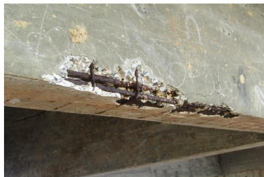
Figura 4: Viga – Deslocamento de concreto com armadura exposta e armadura sem cobrimento.
