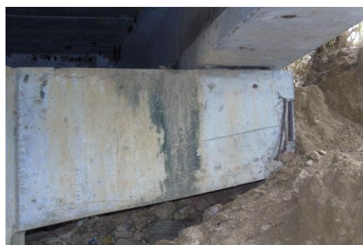
Figura 12: Erosão no talude de aterro e concreto desagregado com armadura exposta no encontro.
