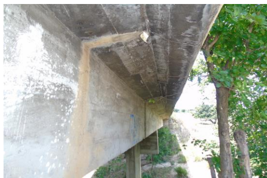
Figura 15: Ponte sobre o Riacho Grande – Lado direito – Pingadeira ineficiente e buzinode danificado.
