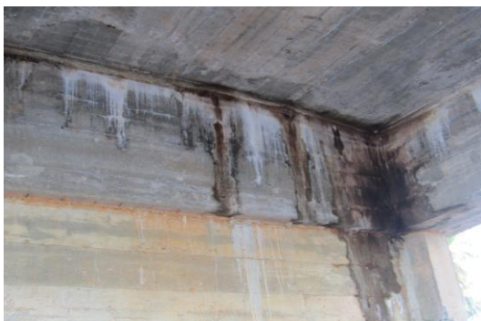
Figura 3: Transversina, viga e laje – Degradação no concreto devido ação biológica.
