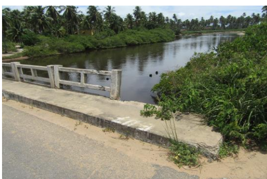
Figura 6: Guarda corpo destruído.
