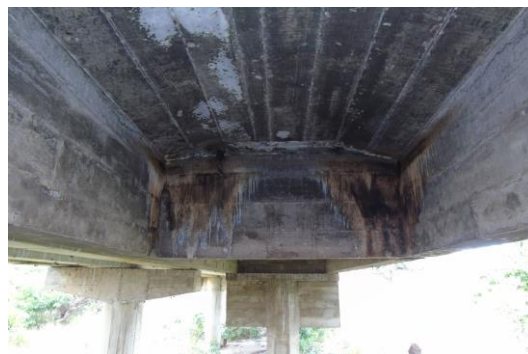
Figura 10: Travessa, Viga, Pilar e Transversina – Degradação no concreto devido ação biológica.
