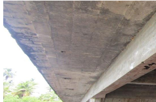
Figura 18: Ponte sobre o Riacho Camandatuba – Buzinotes danificados.
