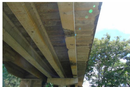
Figura 16: Ponte sobre o Riacho Grande – Lado esquerdo – Pingadeira inexistente.
