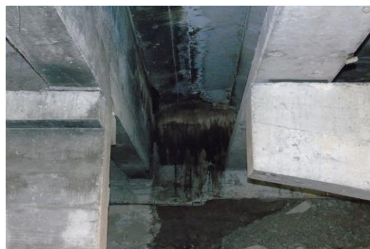
Figura 21: Ponte sobre o Riacho Grande – Manifestações patológicas devido à junta longitudinal.
