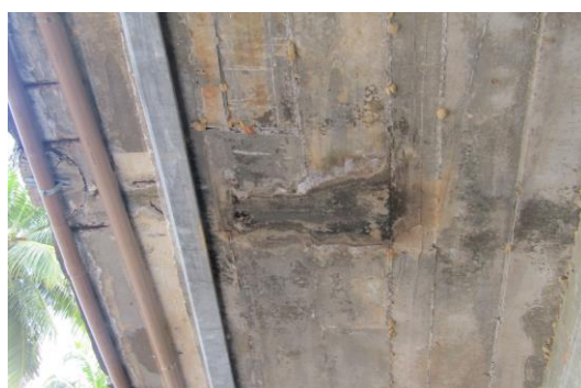
Figura 5: Laje – Infiltração no concreto e concreto desagregado com armadura exposta.
