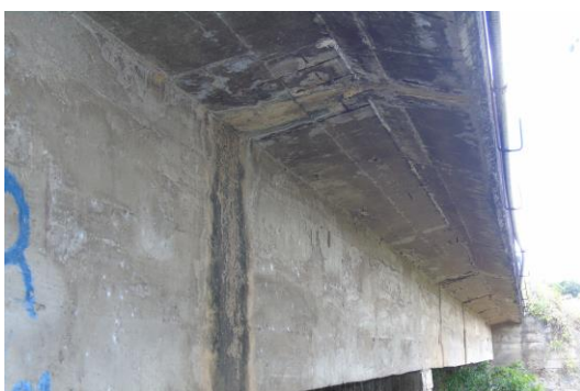
Figura 11: Laje – Infiltração no concreto, lixiviação e concreto desagregado com armadura exposta.
