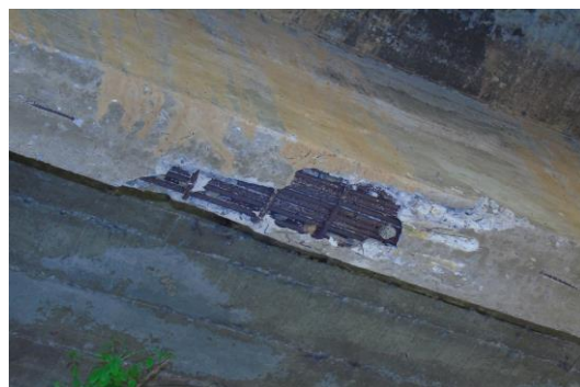
Figura 8: Viga – Nicho de concretagem e armadura sem cobrimento.
