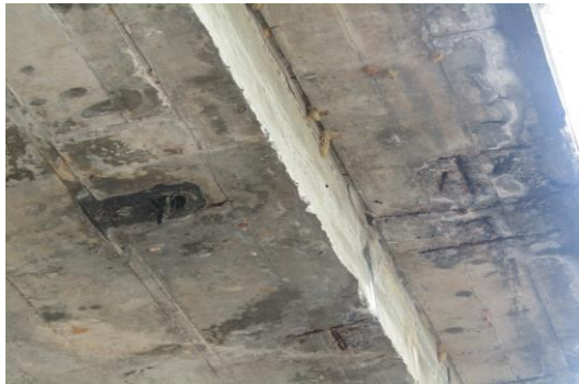
Figura 17: Ponte sobre o Riacho Camandatuba – Pingadeira inexistente e buzinote danificado.
