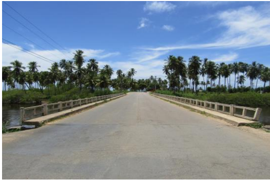
Figura 13: Ponte sobre o Riacho Camandatuba – Ponte sem acostamento e guarda corpo obsoleto.
