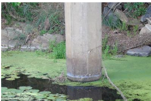
Figura 9: Pilar – Fissura profunda fina e infiltração no concreto.
