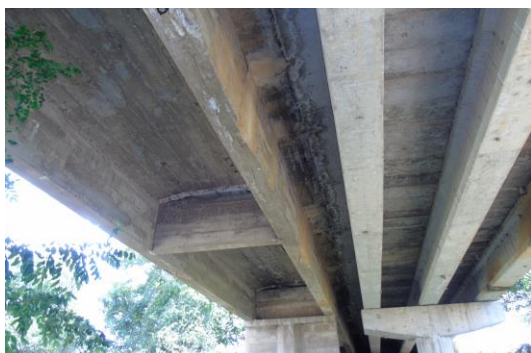
Figura 20: Ponte sobre o Riacho Grande – Manifestações patológicas devido à junta longitudinal.
