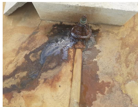
Figura 2: Oxidação da tubulação e manchas de umidade
