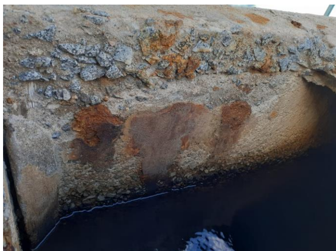
Figura 7: Degradação do concreto no tanque de armazenamento
