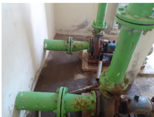
Figura 8: Manchas de umidade na base das bombas
