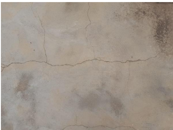
Figura 5: Trincas no piso da ETA
