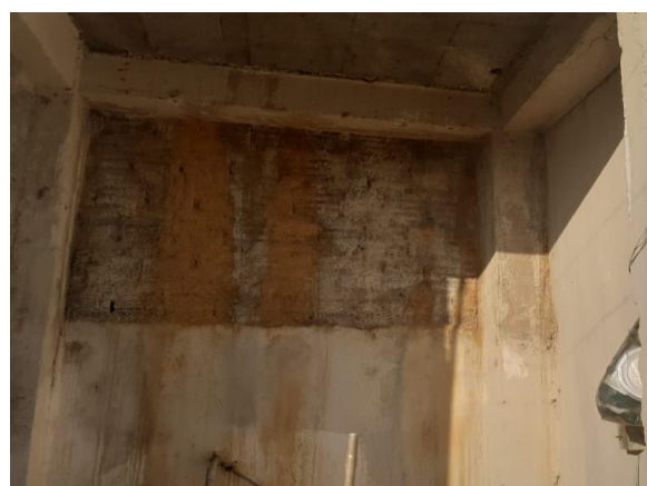
Figura 9: Manchas de umidade na base do reservatório superior
