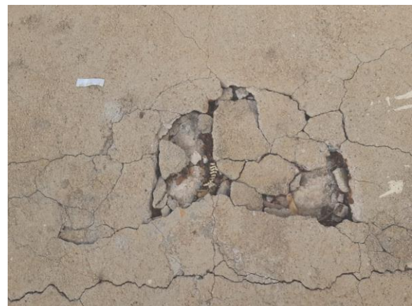
Figura 6: Tincas e fissuras no piso recalçado
