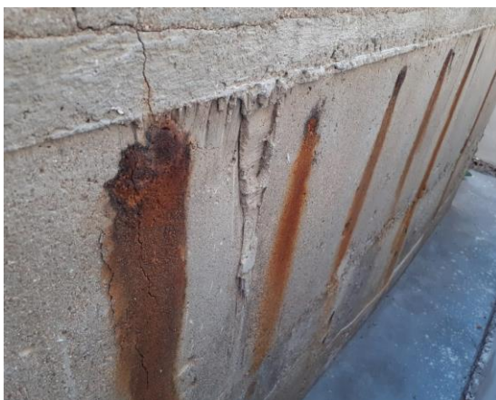
Figura 1: Início da corrosão do aço
