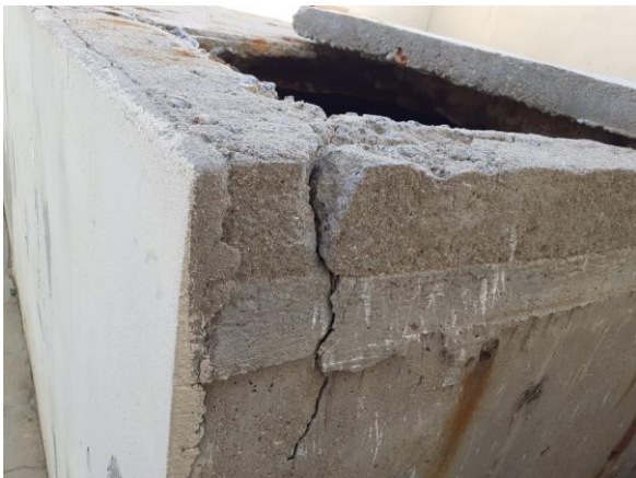
Figura 3: Trinca no tanque de armazenamento de água
