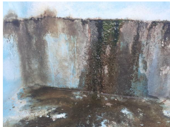
Figura 4: Infiltração na fissura e surgimento de mofo e bolor
