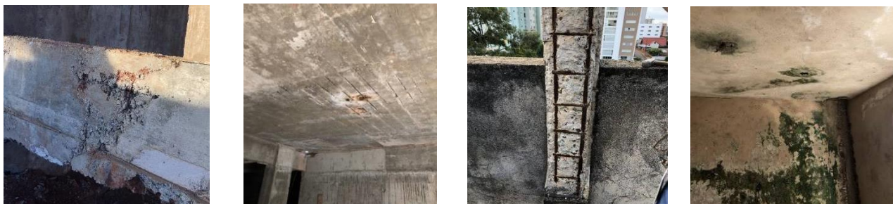
Figura 7 - Nicho de concretagem, corrosão de armaduras, presença de mofo, respectivamente
