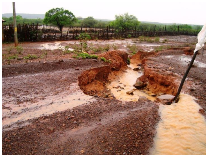
Figura 10: Erosão em um trecho de uma estrada vicinal
