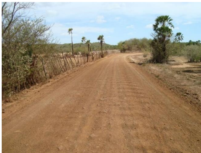
Figura 7: Estrada vicinal comprometida por corrugações
