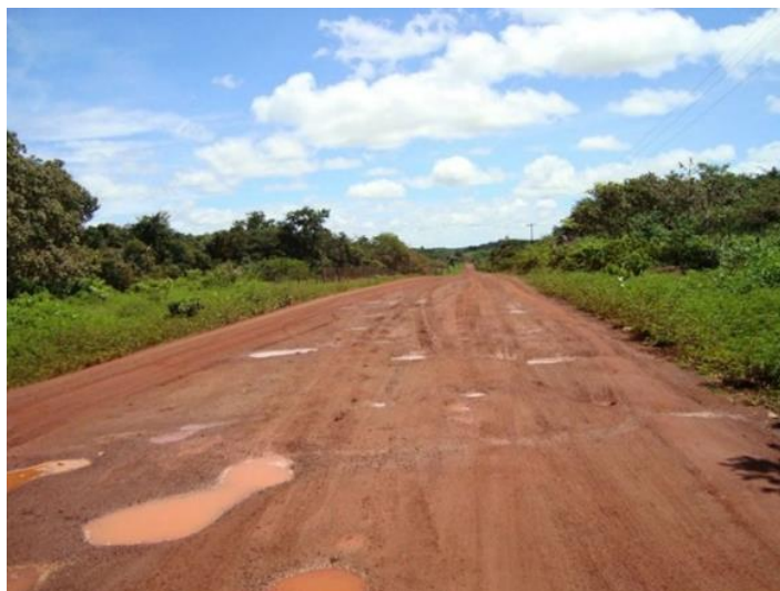
Figura 3: Formação de buracos na pista de rolamento de uma estrada rural
