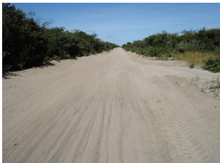
Figura 9: Estrada vicinal comprometida por areiões
