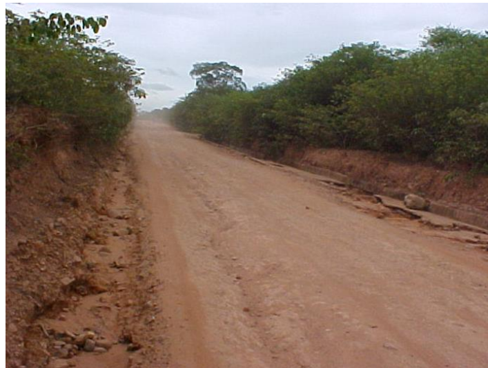
Figura 6: Estrada vicinal defeituosa por conta da drenagem inadequada
