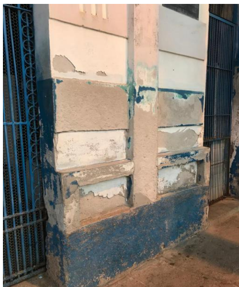
Figura 3 – Destacamento da pintura
