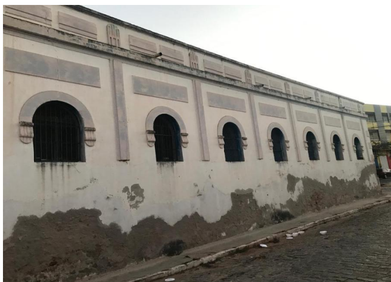
Figura 5 – Bolores e aplicação de reboco de maneira errada
