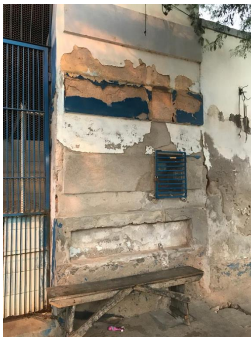
Figura 4 – Degradação da argamassa
