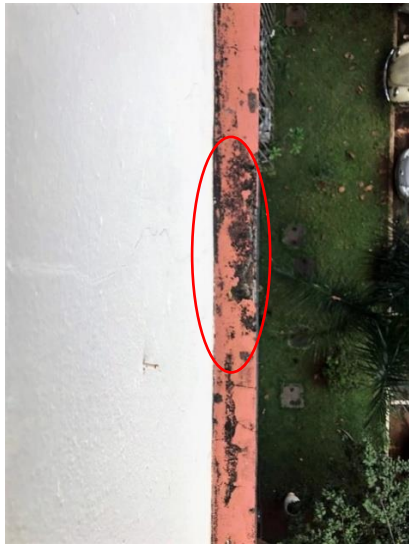
Figura 14: Deslocamento de reboco do ressalto em vermelho da fachada
