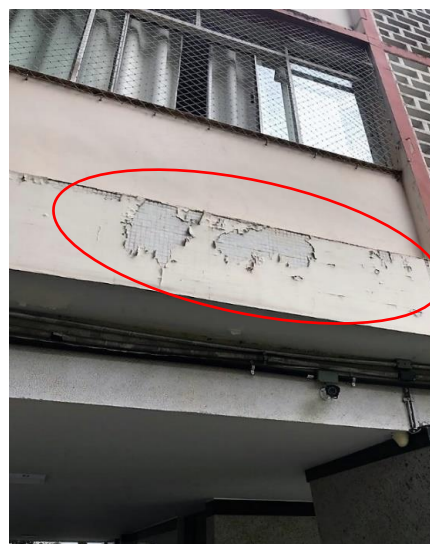
Figura 7: Descascamento da pintura na fachada
