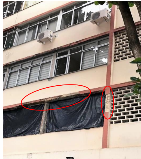
Figura 15: Deslocamento de reboco em vermelho – vista frontal da fachada
