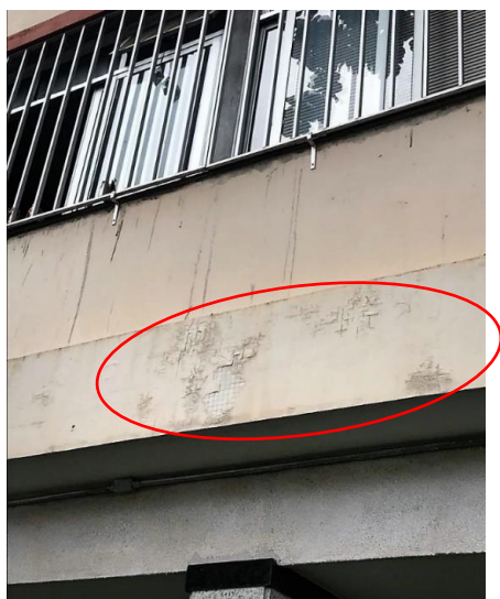
Figura 6: Descascamento da pintura na fachada
