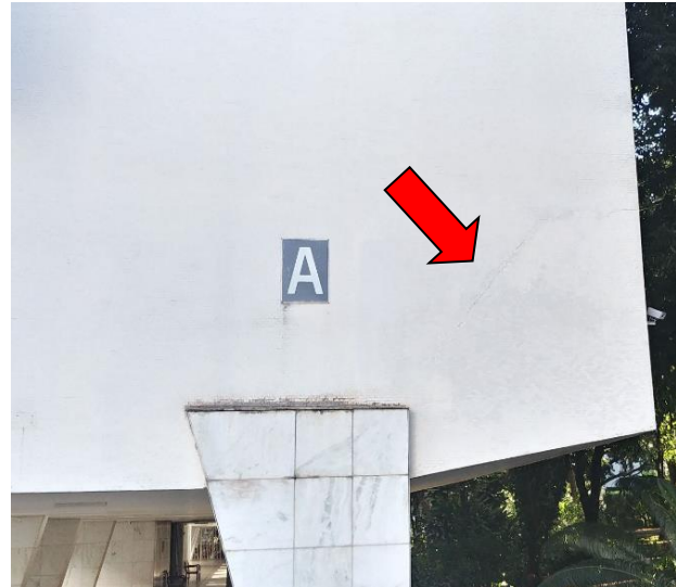
Figura 2: Fissuras e manchas no balanço do edifício
