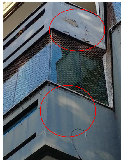
Figura 9: Detalhe da varanda mostrando o descascamento de pintura (círculo de cima) e manchas de escurimento na pintura (círculo de baixo)
