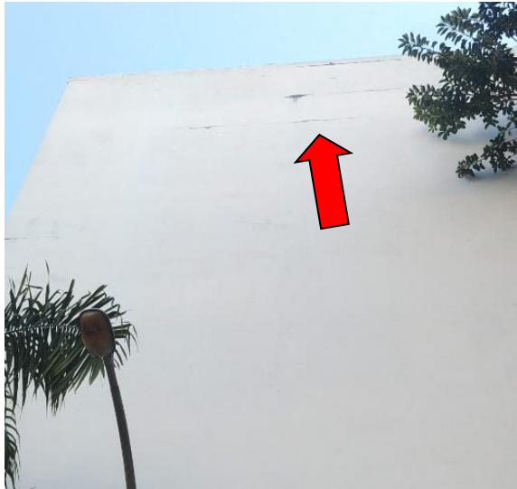
Figura 1: Fissuras e manchas no topo do edifício
