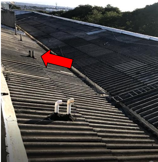
Figura 7: Falta de terminais de ventilação
