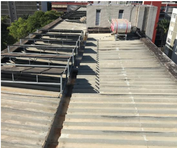
Figura 3: Falta de calafetação das telhas
