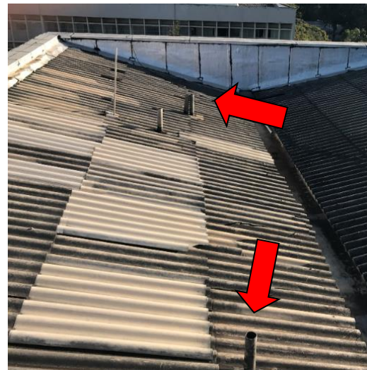
Figura 8: Falta de terminais de ventilação
