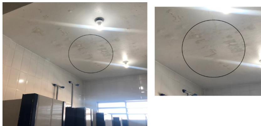
Figura 11: Bolhas no teto do banheiro
