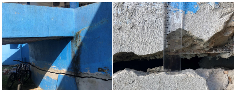
Figura 13: Rachadura abaixo da rampa
