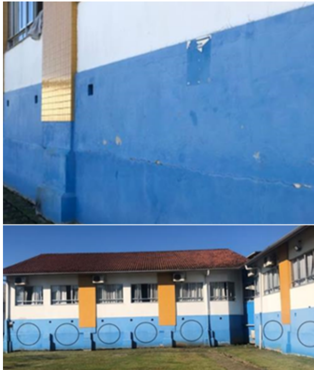
Figura 1: Fachadas com incidência de fissura contínua
