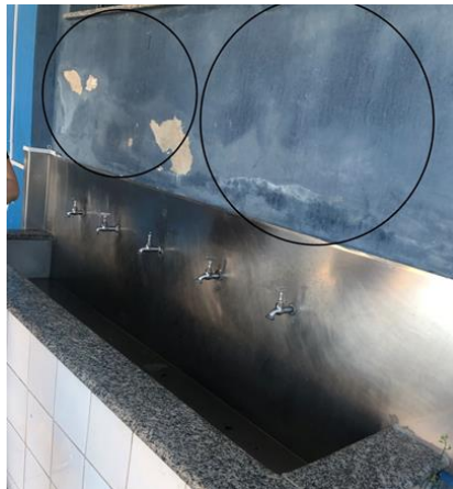
Figura 9: Parede do bebedouro com problema de infiltração de umidade.
