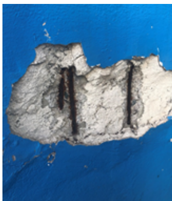
Figura 17: Corrosão de armadura
