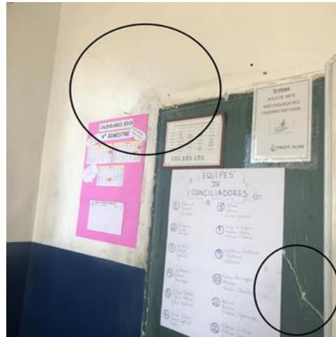
Figura 5: Fissura em 45° na sala de aula
