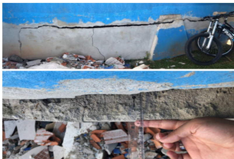
Figura 14: Vista frontal e superior da rachadura abaixo da rampa
