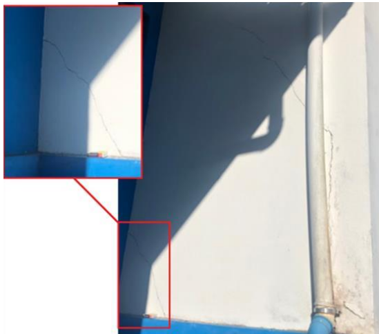
Figura 4: Fissuração longitudinal seguida de inclinada
