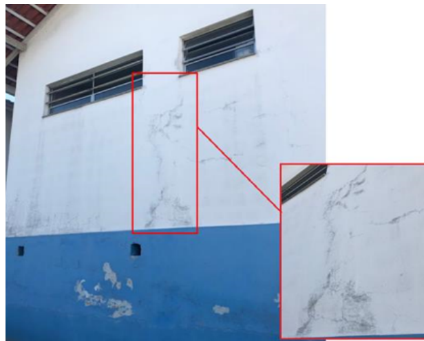
Figura 3: Fissura central em parede externa
