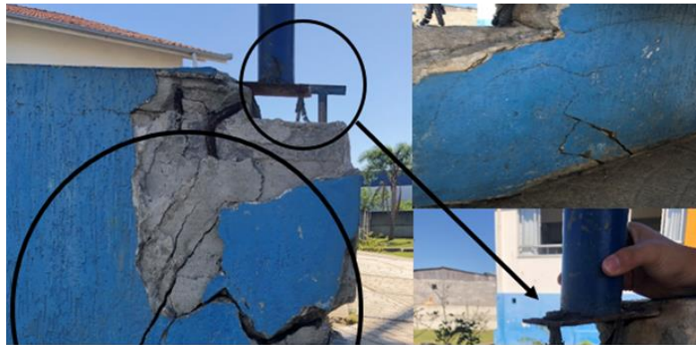
Figura 2: Fissuras de deslocamento
