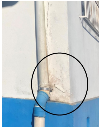
Figura 10: Parede com biodegradação e descascamento
