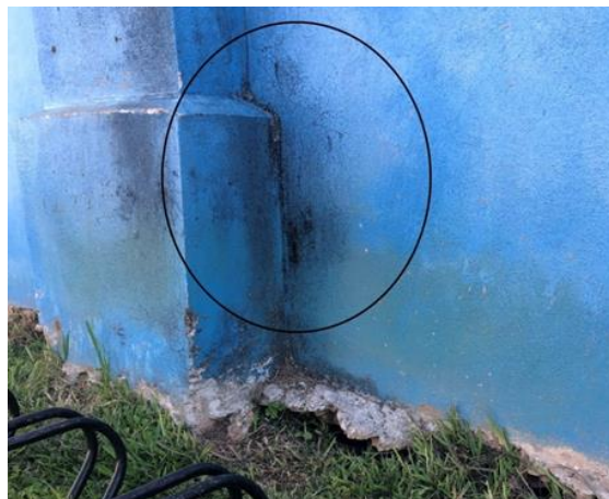
Figura 6: Fachada externa com umidade
