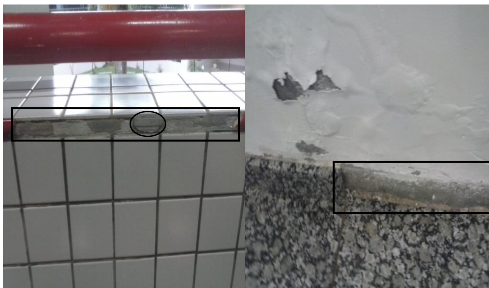
Figura 13: Pontos de descolamento do revestimento cerâmico e de granito.
