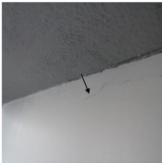
Figura 8: Fissura nas paredes de alvenaria do terceiro pavimento causados pelas movimentações térmicas diferenciais.
