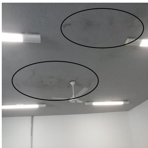
Figura 12: Presença de manchas escurecidas de coloração marrom-avermelhado na laje do terceiro pavimento.
