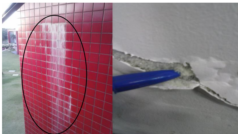
Figura 14: Eflorescências presentes no revestimento cerâmico da área externa da edificação.
