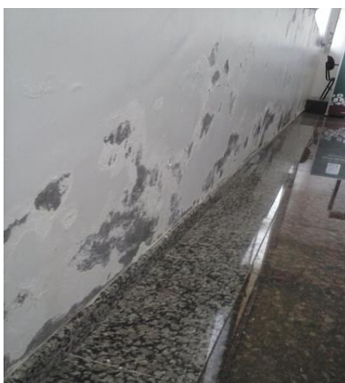
Figura 10: Aspecto da parede prejudicada pelo processo de infiltração.
