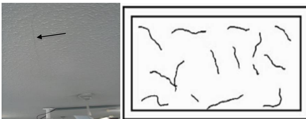
Figura 5: Destaque das fissuras causadas por retração na parte inferior da laje do terceiro pavimento X modelo proposto por Souza e Ripper (1998).
