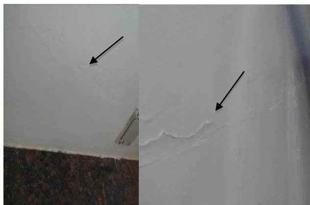
Figura 7: Fissura nas paredes de alvenaria do terceiro pavimento causados pelas movimentações diferenciais.
