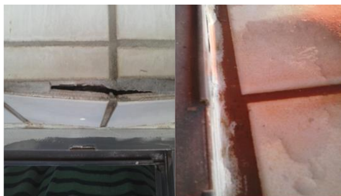
Figura 11: Estado de descolamento de pastilhas no revestimento externo e acúmulo de água nos peitoris.
