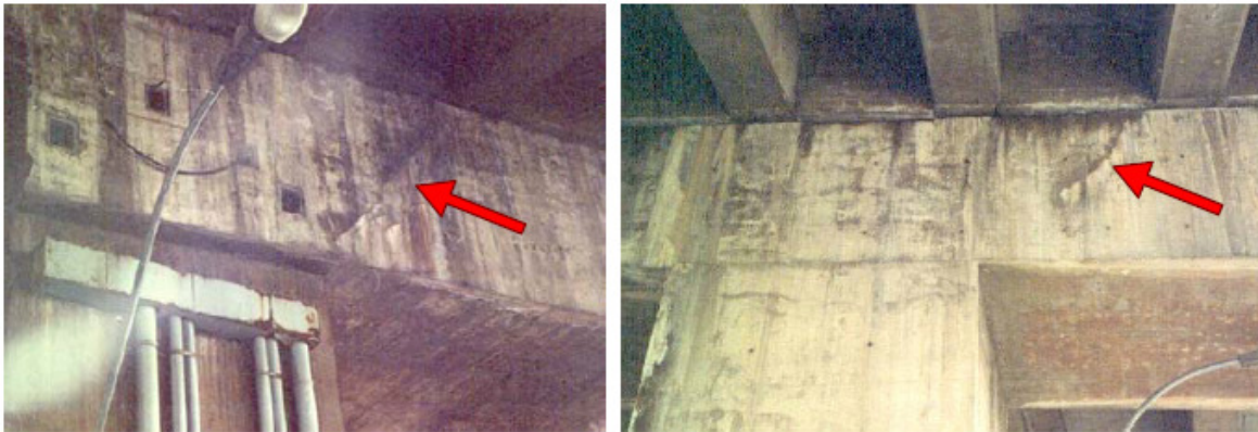
Figura 7: Dois pórticos em concreto armado com fissura inclinada próxima ao apoio
