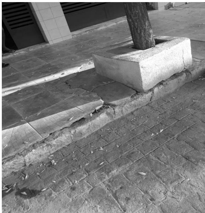
Figura 2: Abaulamento do piso da calçada
