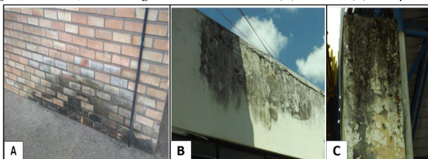
Figura 06 - Mofo, bolor e fungos: em alvenaria interna (A) e externa (B) e em pilar (C).
