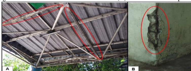
Figura 08 - Corrosão: em estrutura metálica (A) e em armadura de pilar (B).
