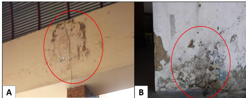
Figura 10 - Infiltração: (A) em viga e (B) em alvenaria
