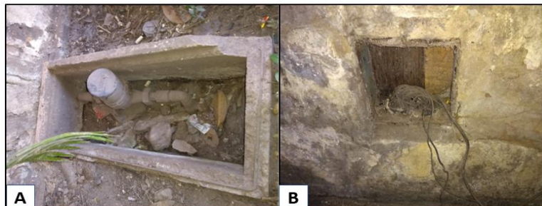
Figura 07 - Degradação de instalação: hidráulica (A) e elétrica (B).
