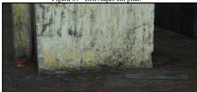
Figura 09 - Lixiviação em pilar.
