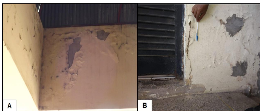
Figura 12 - Bolhas: em viga (A) e parede (B).
