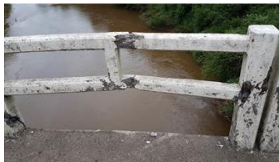
Figura 5 – Guarda corpo danificado
