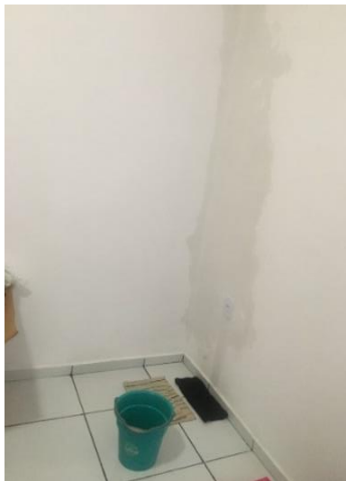
Figura 04: Revestimento em pintura danificado
