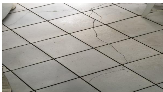
Figura 17: Trincas em revestimento cerâmico
