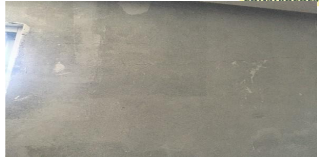
Figura 15: Fissura por sobrecargas em torno de abertura
