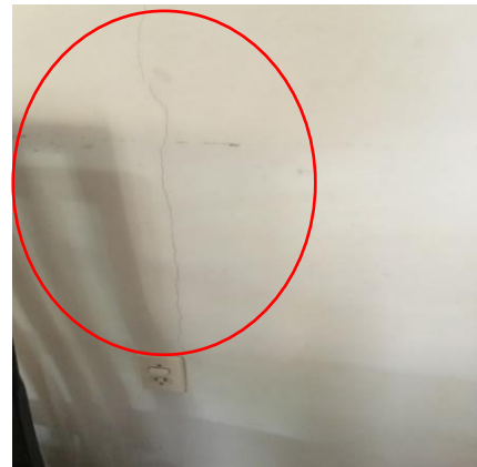
Figura 13: Fissuras verticais em paredes por retração da alvenaria
