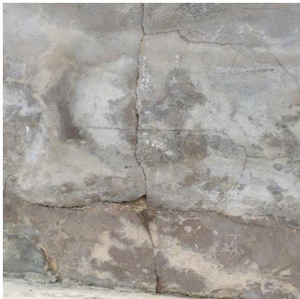
Figura 12: Fissuras de destacamento de paredes de alvenaria por retração
