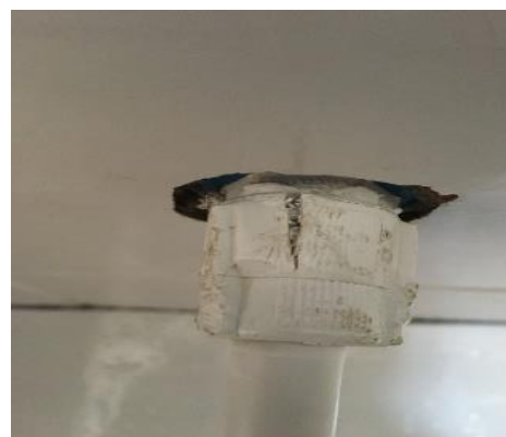
Figura 02: Engates flexíveis - ruptura na porca
