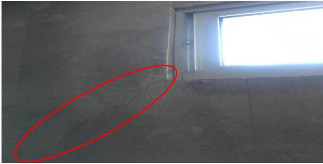
Figura 14: Fissura por sobrecargas em torno de abertura
