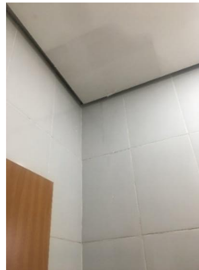
Figura 05: Placas de gesso danificadas
