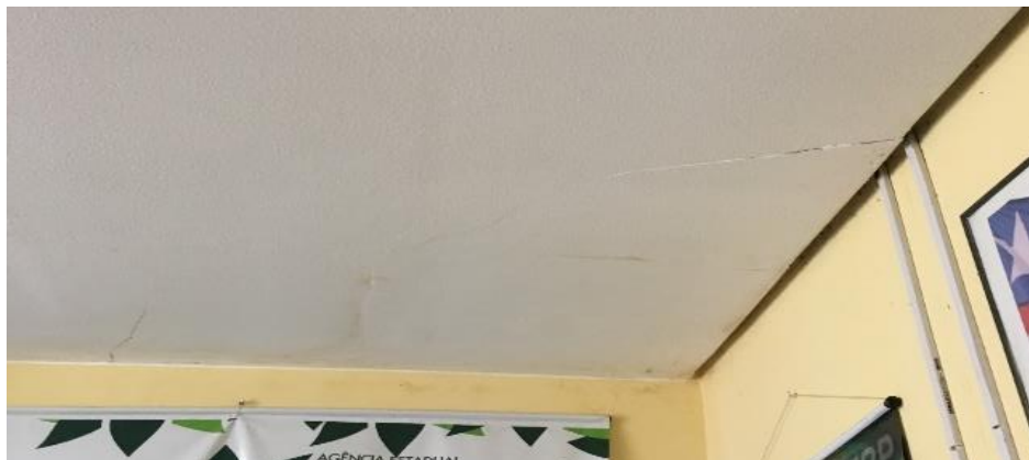
Figura 19: Fissura no forro de gesso
