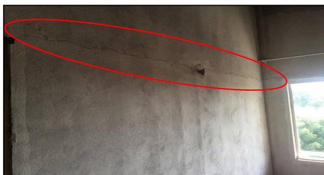
Figura 10: Fissuras horizontais por movimentação térmica da laje
