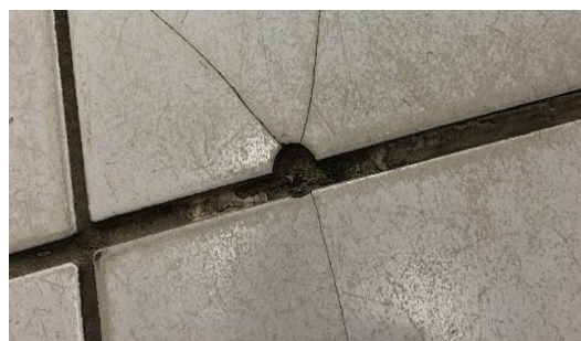
Figura 18: Deterioração de junta
