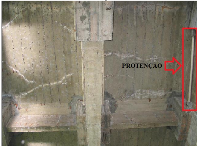
Figura 10-A e 10-B: Fissuras e eflorescência nas lajes.
