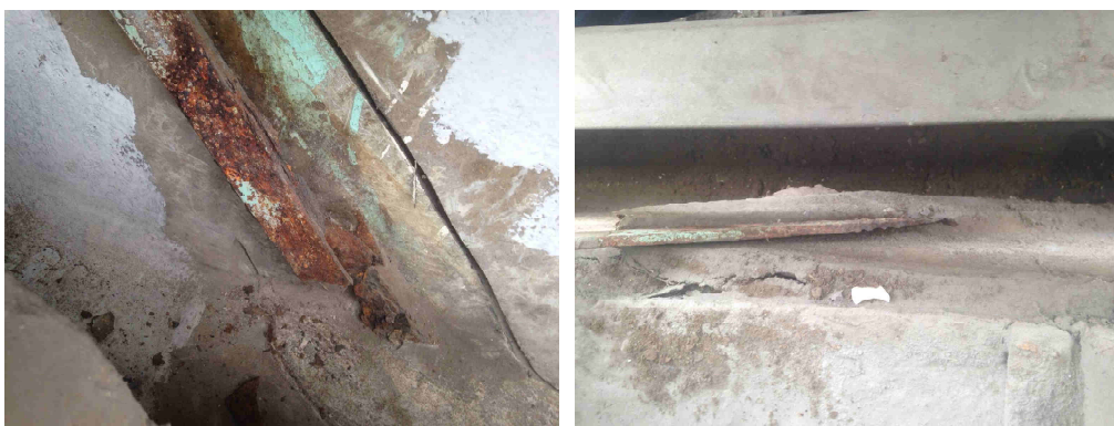
Figura 4: Ruptura do tirante de reforço por corrosão.
