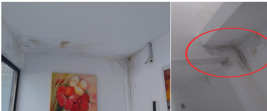
Figura 8: Infiltrações presentes no bloco A (a) hall de entrada (b) ultimo andar
