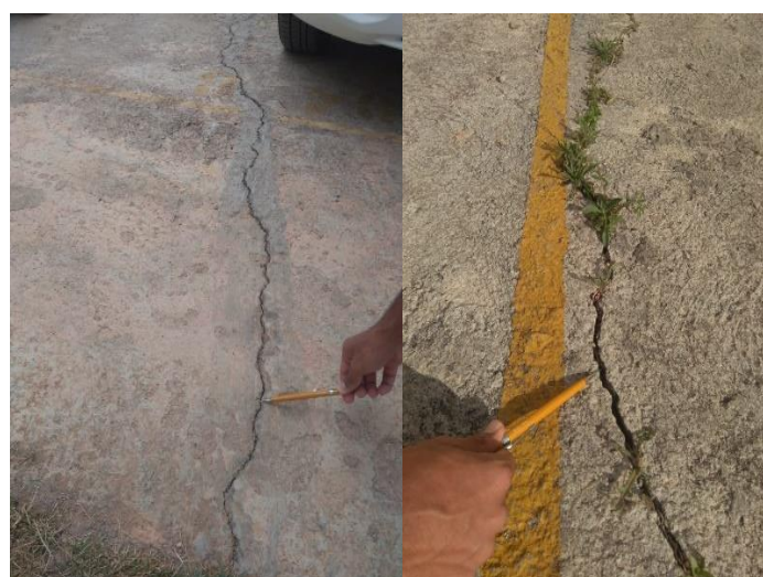
Figura 7: Fissuras presentes nos estacionamentos (a) bloco C (b) bloco D
