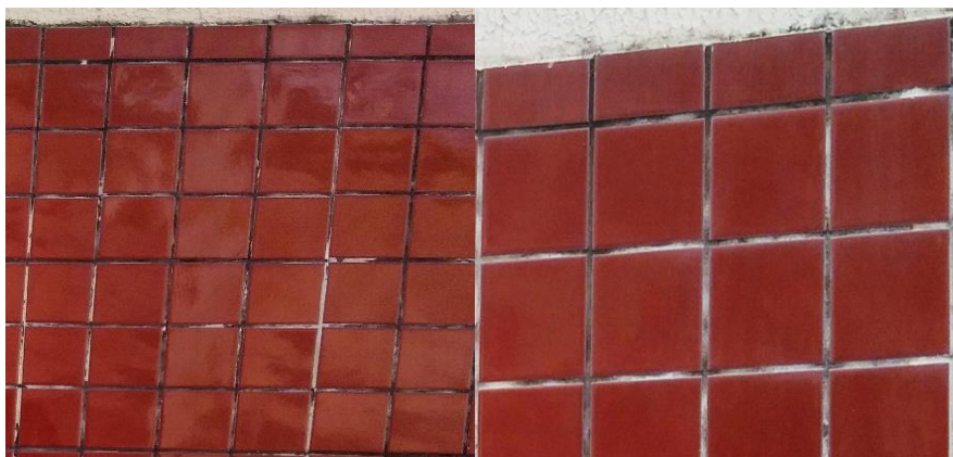
Figura 3: Deterioração das juntas de assentamento (a) bloco A (b) bloco B
