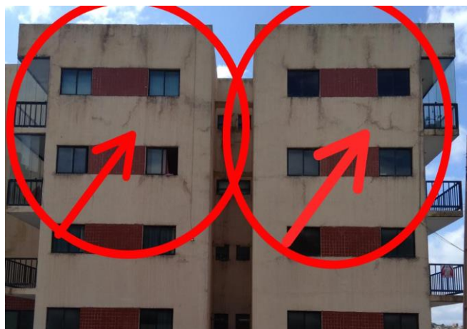
Figura 4: Manchas localizada na fachada principal do bloco A
