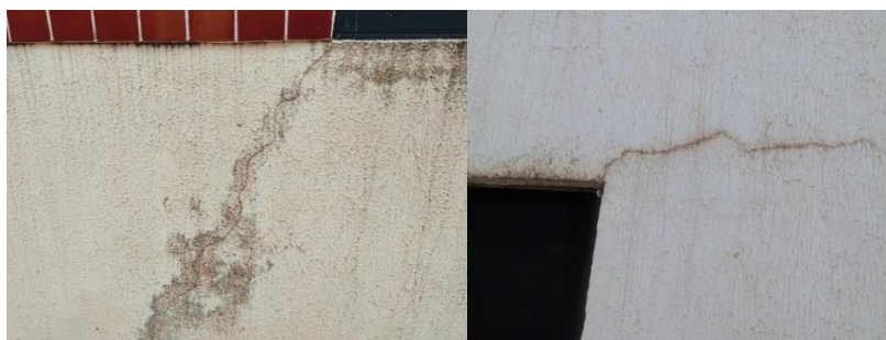
Figura 5: Fissuras apresentadas nas janelas do bloco A (a) parte inferior (b) parte superior
