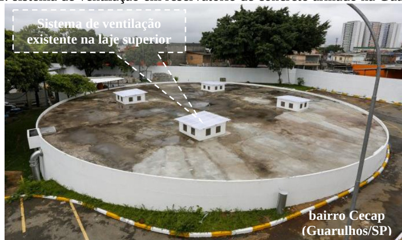
Figura 11: sistema de ventilação em reservatório de concreto armado na Guarulhos/SP.
