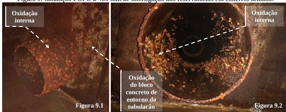
Figura 9: tubulação FOFO \varnothing 400 mm de interligação dos reservatórios em concreto armado.
