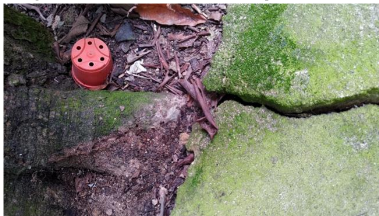
Figura 8 – Interferência física de raiz em piso de concreto.
