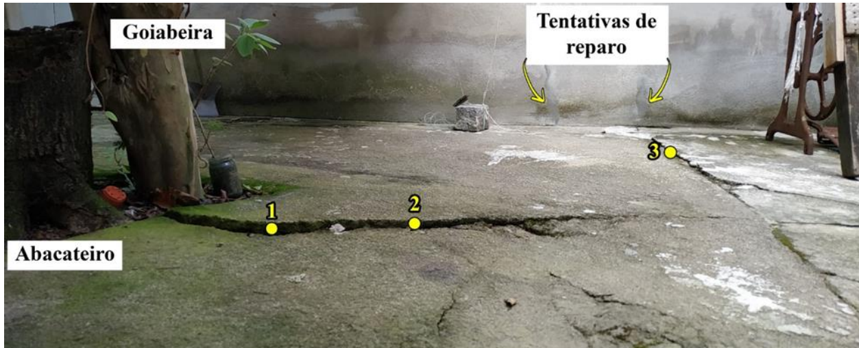
Figura 6 – Indicação das árvores, sinalização dos pontos 1, 2 e 3, e tentativas de reparo de fissuras.
