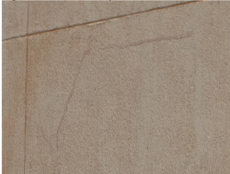
Figura 4 – Sinais de manutenções corretivas nas trincas/fissuras
