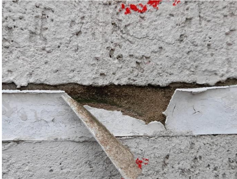
Figura 8 – Dimensões inadequadas da junta de movimentação
