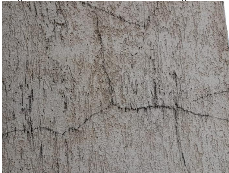
Figura 6 – Trincas/Fissuras nos revestimentos argamassados
