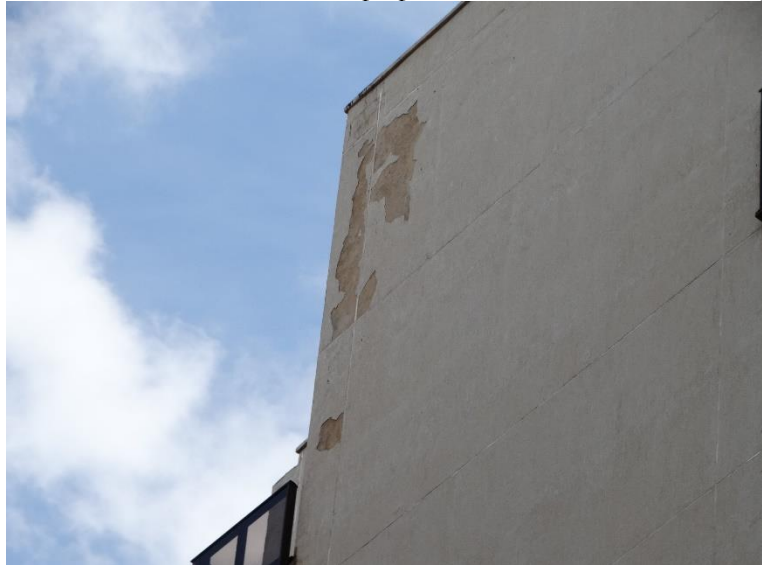
Figura 2 – Falhas no revestimento tipo pintura texturizada da fachada poente
