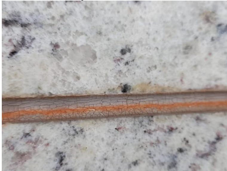
Figura 9 – Material selante das juntas do revestimento em rocha natural degradado
