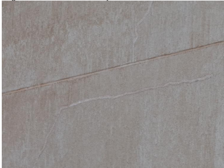
Figura 3 – Sinais de manutenções corretivas nas trincas/fissuras
