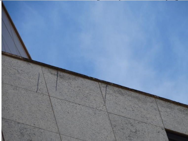
Figura 5 – Manchas de umidade no granito por ausência de pingadeiras
