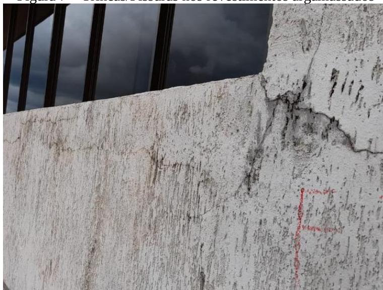
Figura 7 – Trincas/Fissuras nos revestimentos argamassados
