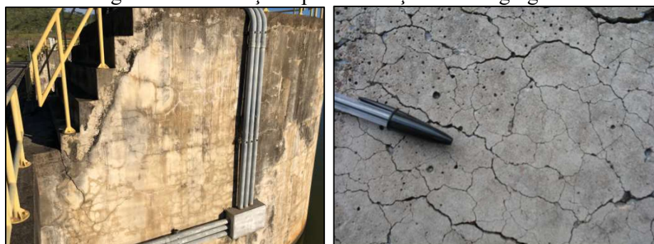
Figura 1 – Fissuração típica da reação álcali-agregado.
