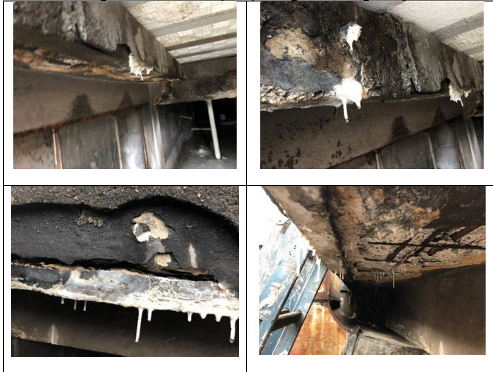
Figura 9 – Manifestações patológicas em viga e laje
