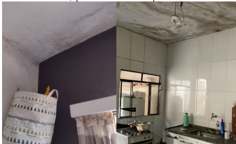
Figura 3 - Ocorrências de infiltração na cobertura de um quarto, reforma do cliente C16, e cozinha do cliente C16, que foram reformados posteriormente
