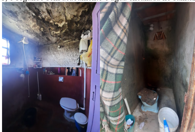
Figura 4 - Ocorrências de infiltração na cobertura de dois banheiros, reforma dos beneficiários B10 e B11, o segundo sem acabamento e água encanada no sanitário
