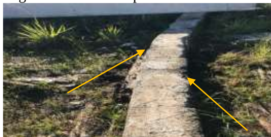
Figura 8 – Elemento pré-fabricado fraturado
