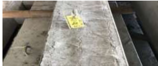
Figura 5 - Retração na linha da armadura
