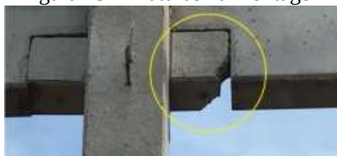
Figura 13 – Fraturas na montagem
