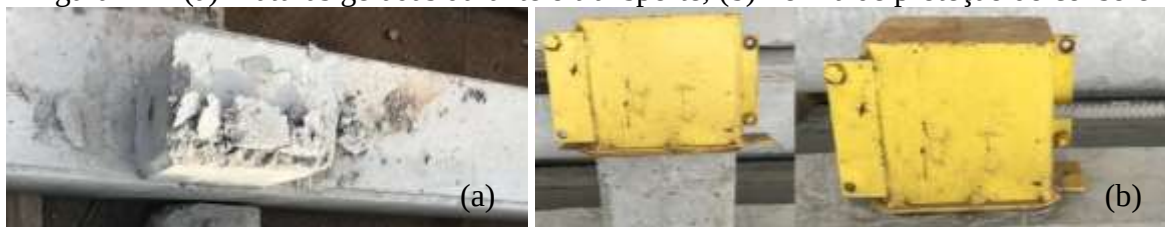
Figura 11 – (a) Fraturas geradas durante o transporte; (b) Fôrma de proteção do console
