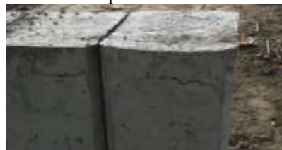
Figura 6 – Fissuras por adensamento inadequado
