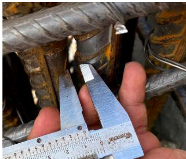
Figura 2- espaçamento entre barras menor que o estabelecido por norma
