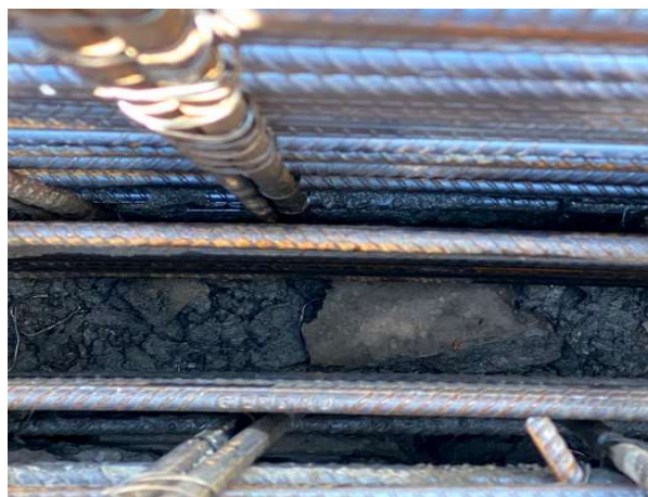
Figura 10- Presença de sujidades na interface concreto velho/concreto novo
