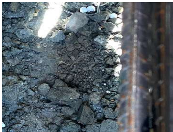
Figura 9 - Presença de sujidades na interface concreto velho/concreto novo
