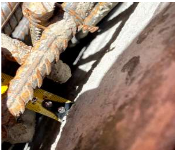
Figura 3 – Espaço insuficiente do cobrimento e em desacordo com o projeto
