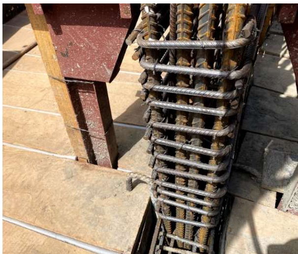
Figura 1 – Armadura densa, com espaçamento entre barras insuficiente
