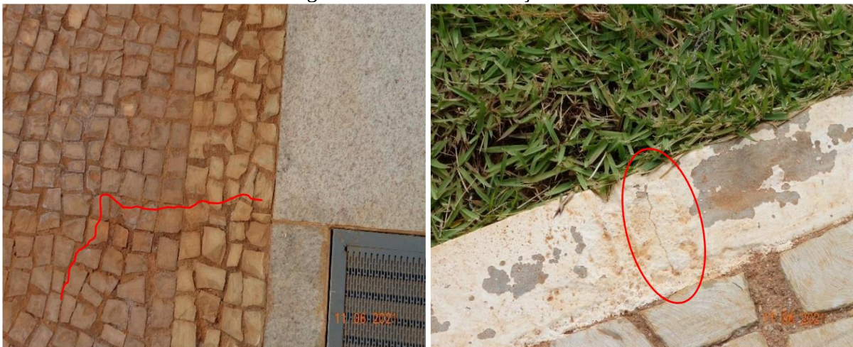
Figura 16 – Fissuras nas calçadas
