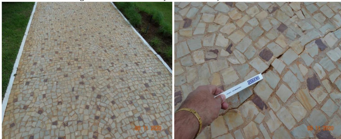
Figura 5 – Fissuras nas calçadas da edificação habitada “A”
