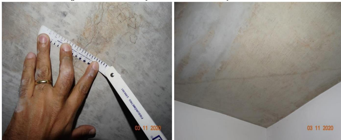
Figura 4 – Fissuras na laje do subsolo da edificação habitada “A”
