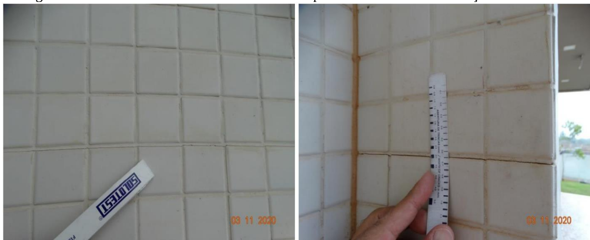
Figura 7 – Fissuras no revestimento cerâmico dos panos de fachada da edificação habitada “B”
