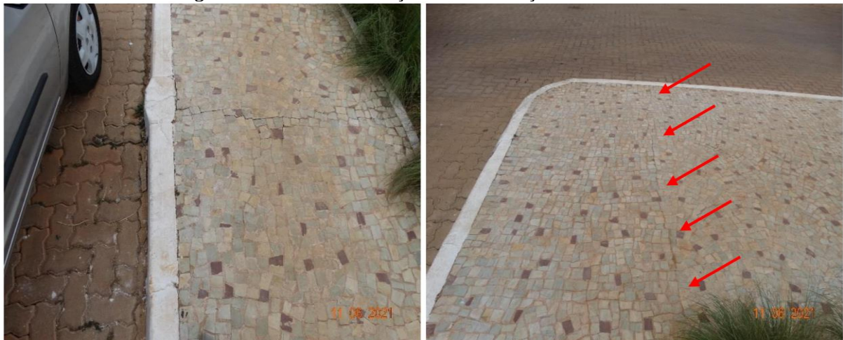
Figura 9 – Fissuras nas calçadas da edificação habitada “A”
