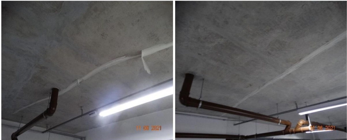
Figura 8 – Fissuras no subsolo da edificação habitada “A” com fitas adesivas utilizadas durante as manutenções corretivas
