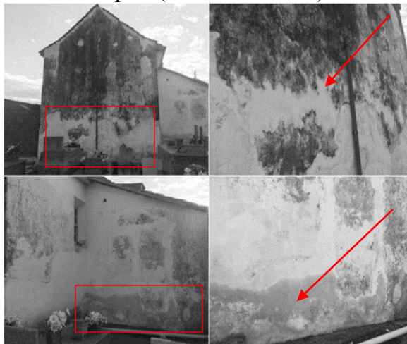
Figura 4 - Eflorescências profundas na parte posterior a capela (Fachada Sudeste).
