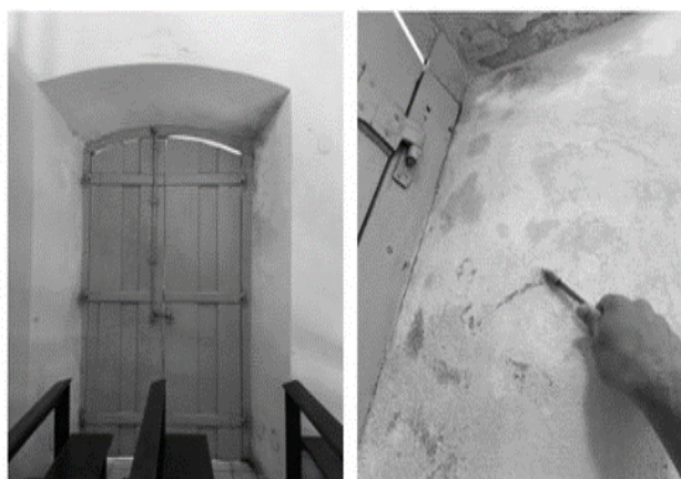
Figura 5 - Principais eflorescências notadas próximas às aberturas da estrutura.
