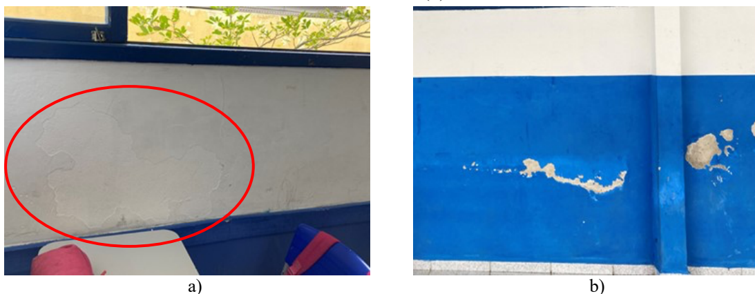
Figura 1 - Descascamento na parede abaixo da janela na sala de aula 7 (a) e na parede do corredor da sala de aula 6 (b).
