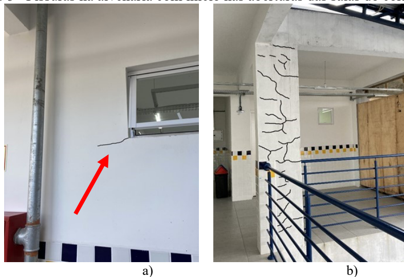
Figura 6 - Fissuras na alvenaria com início nas aberturas das salas do corredor 1.
