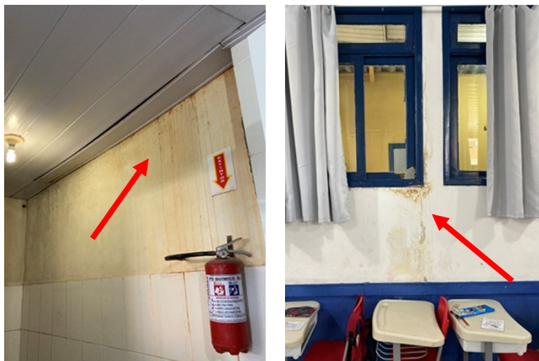
Figura 2 - Infiltrações e manchas na parede da cozinha (a) e na parede abaixo da janela na sala de aula 3 (b).
