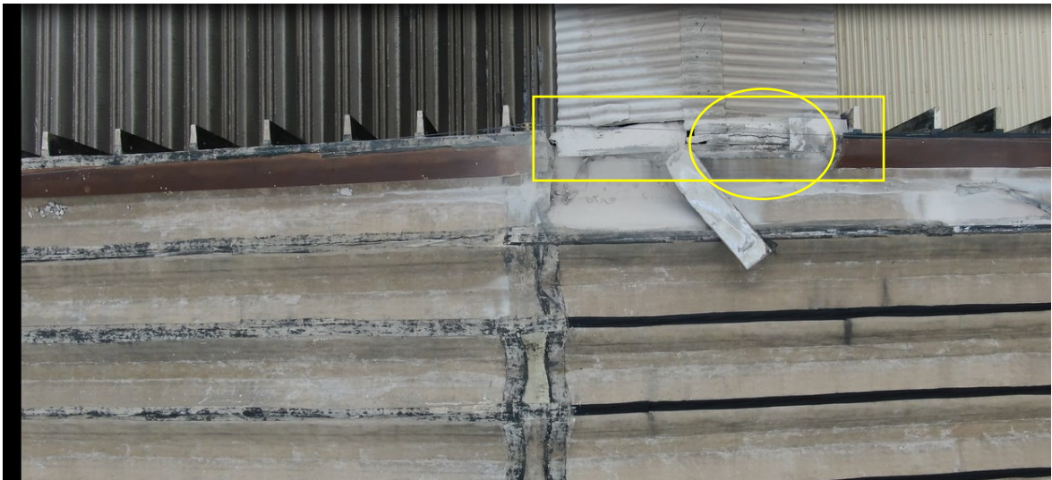
Figura 13: Perímetro sem rufo, com concreto deslocado e armadura exposta;
