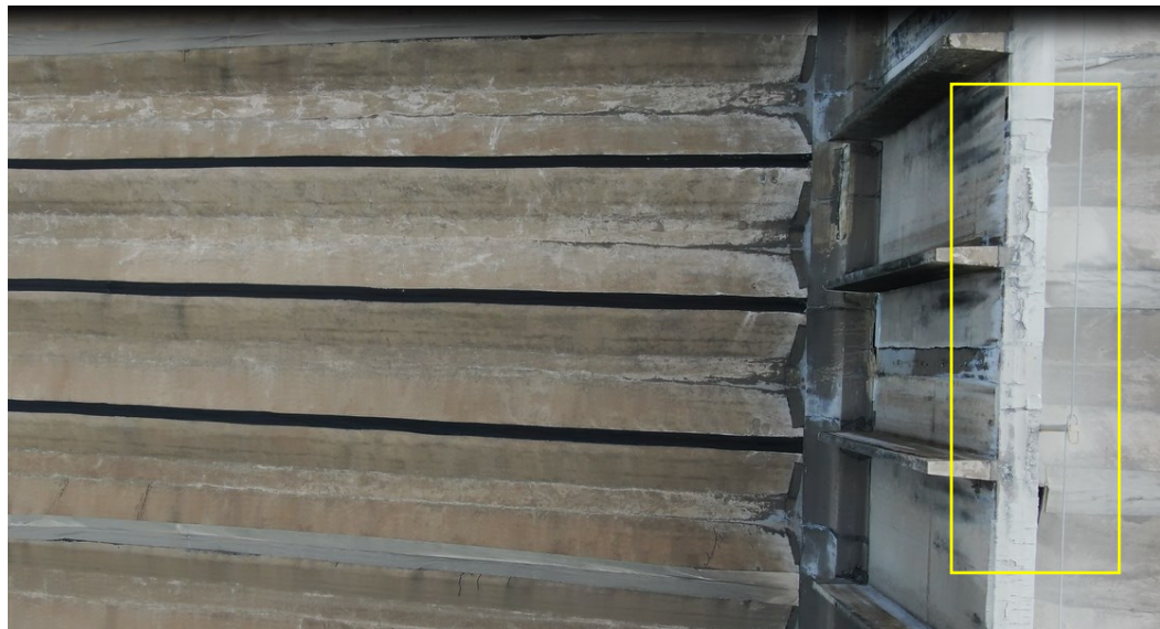
Figura 8: Descamação do concreto e fissuras na parte superior da placa de fechamento vertical da cobertura;
