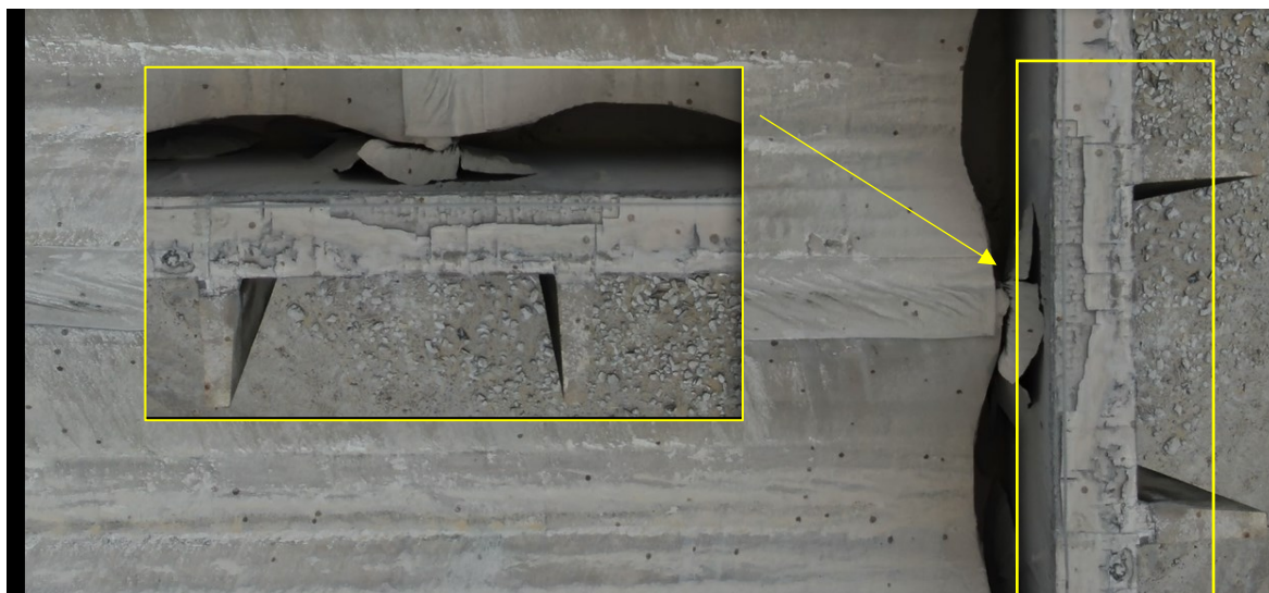
Figura 92: Deslocamento da parede interna da placa de fechamento vertical – calha de captação da água do telhado;
