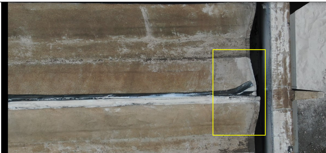
Figura 41: Desprendimento da manta de impermeabilização utilizada na junção das telhas de concreto;
