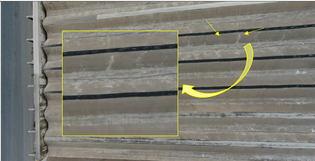
Figura 4: Microfissuras nas telhas em concreto com pequenas formações de eflorescência;
