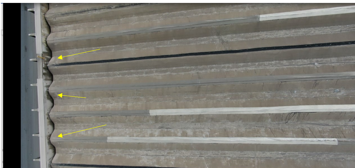
Figura 5: Acumulo de sujidades na parede da calha de captação de água do telhado;
