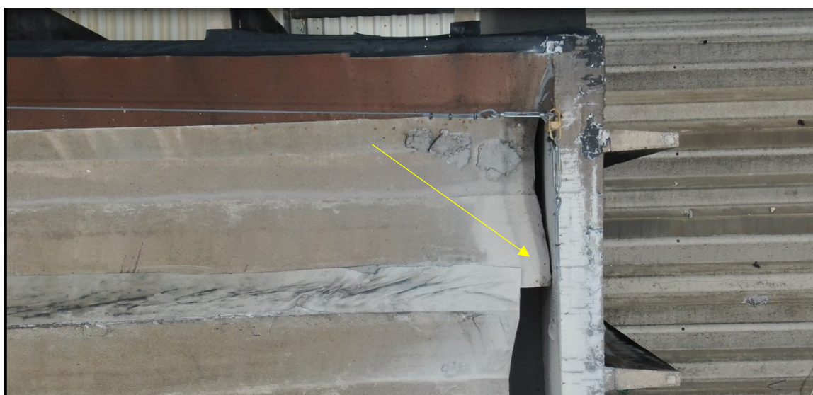
Figura 52: telha fora do apoio bilateral, na extremidade em nível mais baixo da anterior e sem afastamento suficiente entre a calha;
