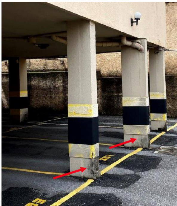
Figura 4 - Manifestações patológicas presentes nos pilares do pavimento garagem.
