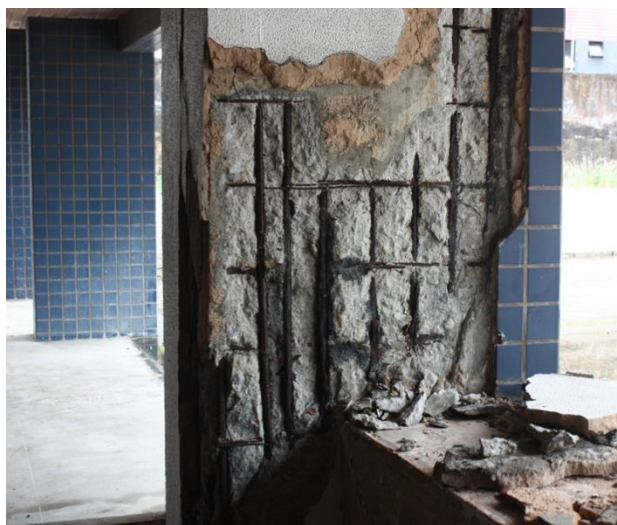
Figura 1 - Corrosão das armaduras em decorrência da carbonatação.
