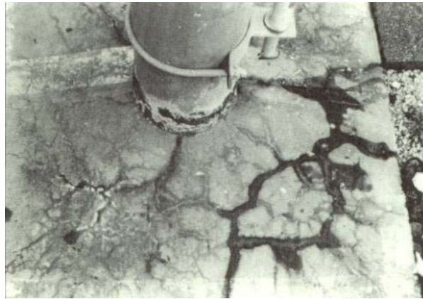
Figura 1 – Base de torre de rede elétrica com fissuras em forma de “mapa”
