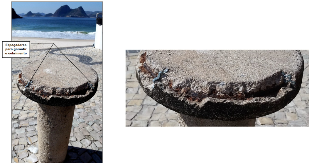
Figura 5 – Banco em concreto armado deteriorado pela corrosão
