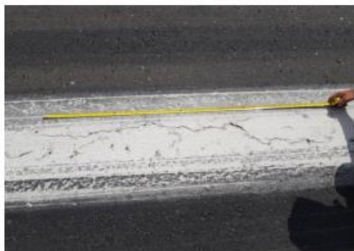
Figura 9a- Trinca isolada
