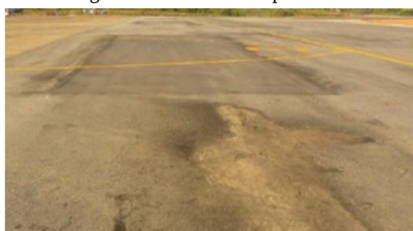
Figura 5 – Remendo em pavimento
