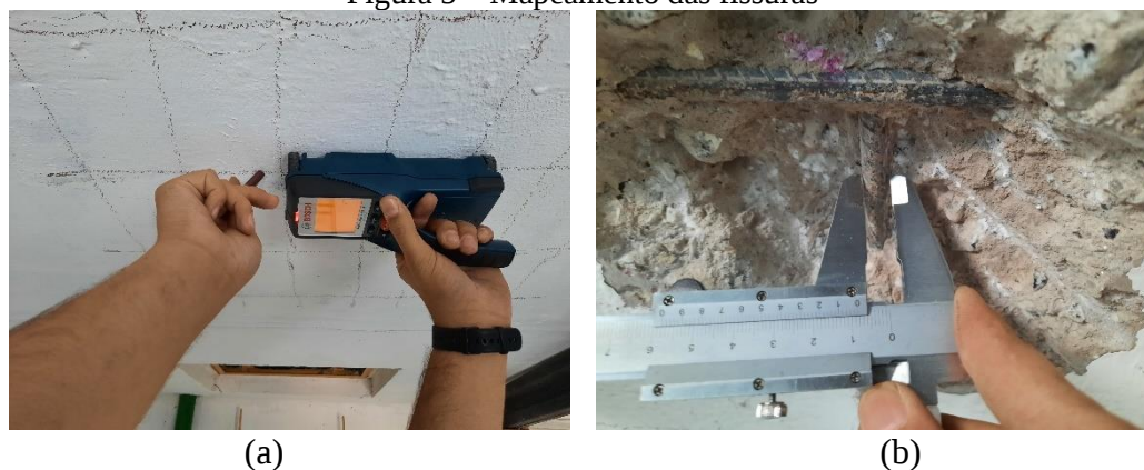
Figura 5 – Mapeamento das fissuras
