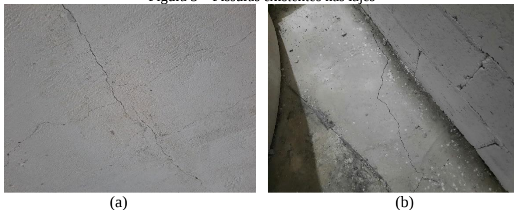
Figura 3 – Fissuras existentes nas lajes
