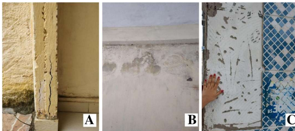
A-Rachadura em Pilar; B- Parede com infiltração; C- Parede com descolamento cerâmico
