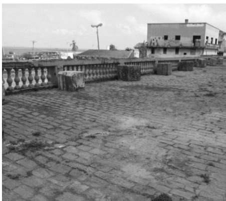
Figura 7 - Recalque no piso externo Fonte: Arquivos IPHAN (2017)
