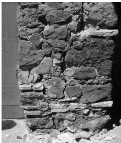
Figura 6 - Pilares com perda de pedras lamelares e argila siltosa
