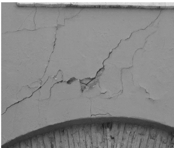
Figura 4 – Trincas acima dos arcos do claustro Fonte: Wadson Carvalho (2017)
