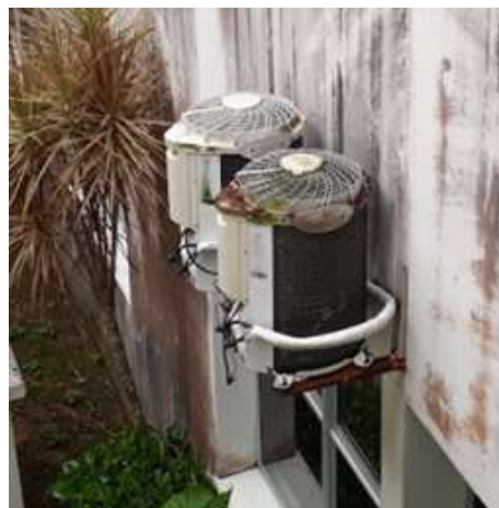
Figura 13 - Equipamentos do ar condicionado no jardim da edificação.
