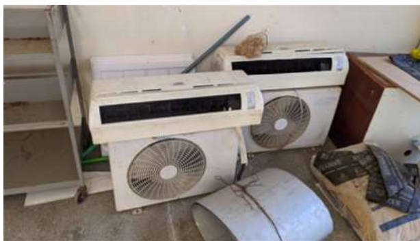
Figura 16 - Equipamentos do sistema de refrigeração com defeitos e estocados no prédio público.
