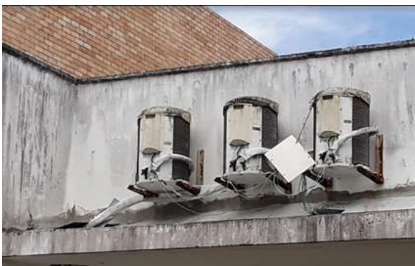
Figura 12 - Equipamentos sem proteção fixados na platibanda da edificação.
