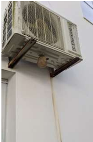
Figura 10 – Unidade condensadora no jardim do CETEC/UFRB.
