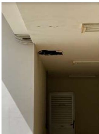
Figura 15 - Forro de gesso em placas danificado (com abertura proposital) no primeiro andar da edificação.
