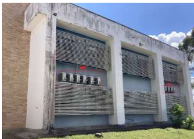
Figura 4 - Fachada posterior da sede do CETEC com unidades condensadoras do sistema de refrigeração (2022).
