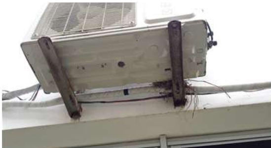
Figura 14 – Unidade condensadora com apoios fixados na parede, apresentando corrosão.
