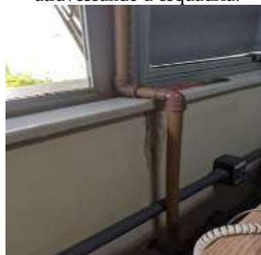
Figura 6 - Tubulação de PVC aparente, atravessando a esquadria.
