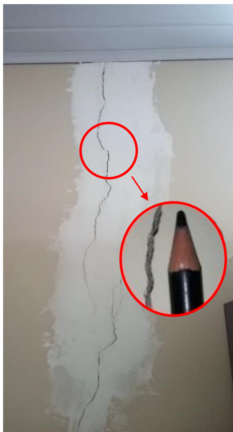
Figura 2 – Parede da sala com rachadura vertical
