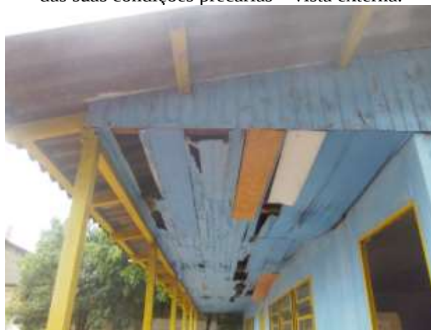
Figura 3 – Edificação vistoriada, correspondendo a um imóvel escolar, em madeira, interditado em função das suas condições precárias – vista externa.
