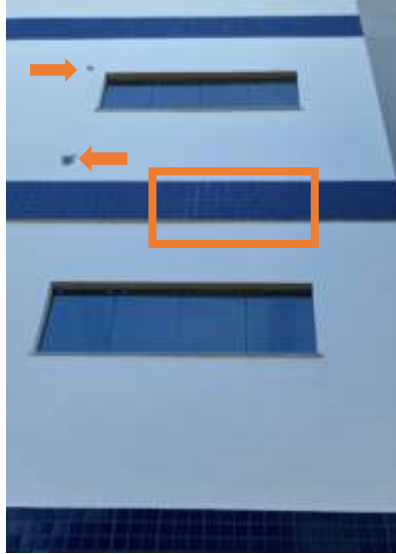
Figura 5 – Eflorescência no revestimento cerâmico e danos no reboco.
