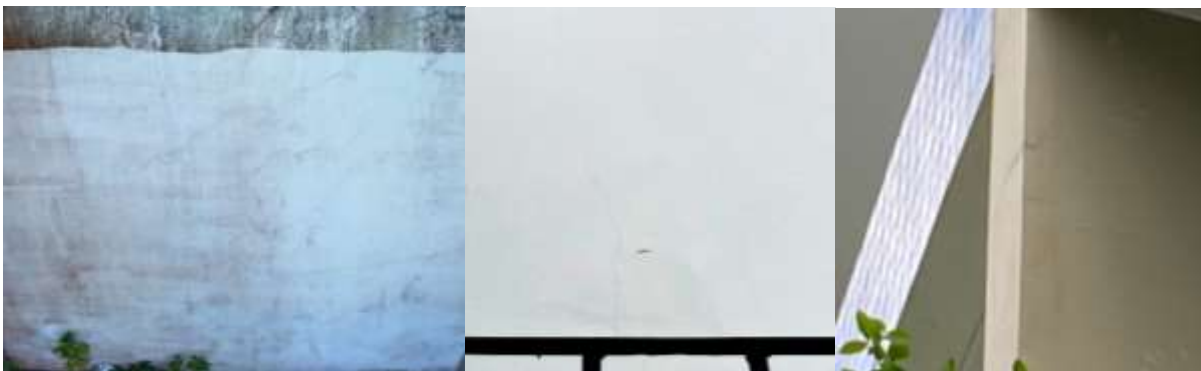
Figura 4 – Microfissuras e fissuras.
