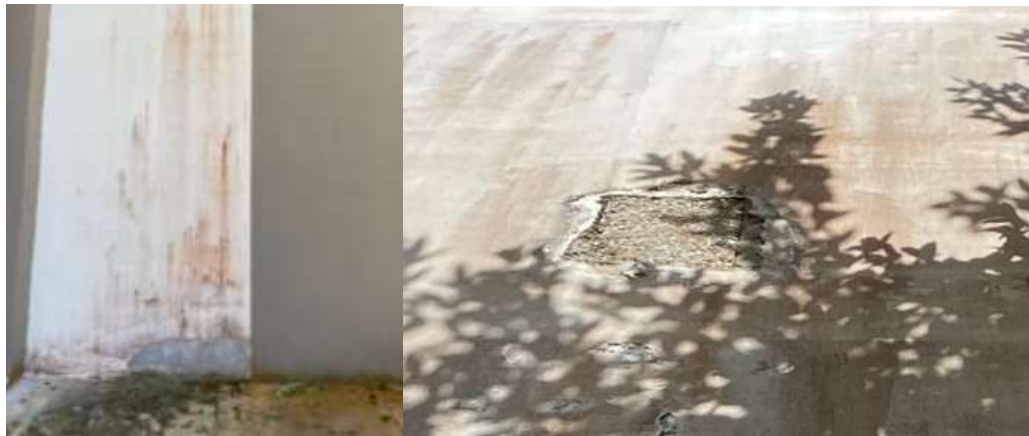
Figura 6 – Descolamento na pintura.
