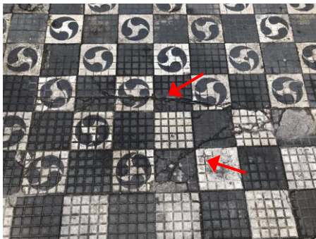
Figura 5 - Ladrilhos hidráulicos danificados Calçada Bairro Liberdade-SP
