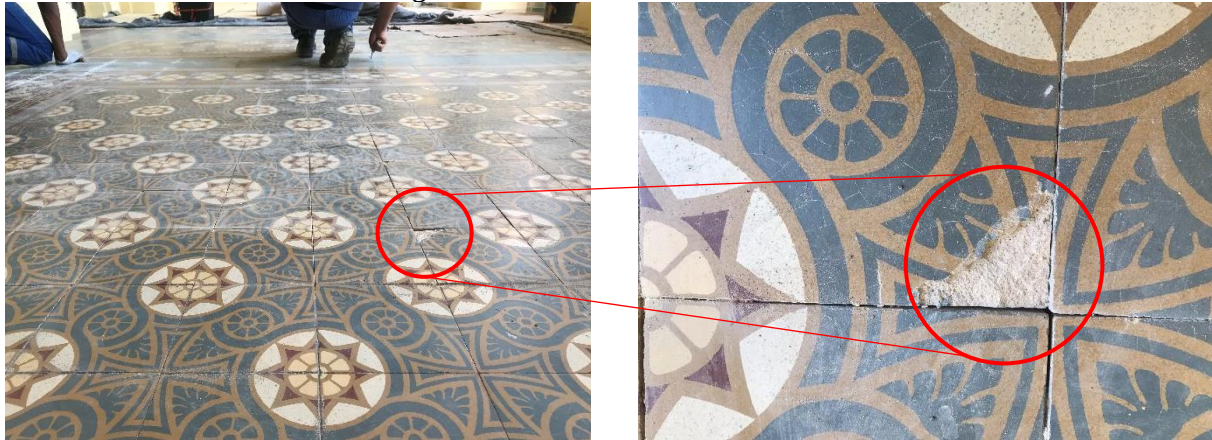
Figuras 11 e 12 – Ladrilho danificado.
