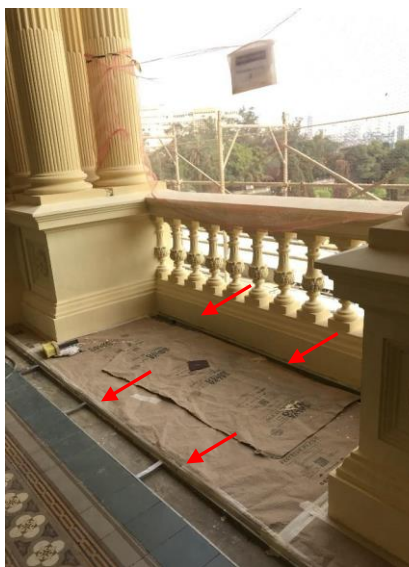
Figura 8 – Trechos com ladrilhos retirados.
