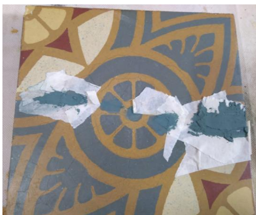
Figura 15 – Fissuras do ladrilho preenchida com rejunte acrílico pigmentado.
