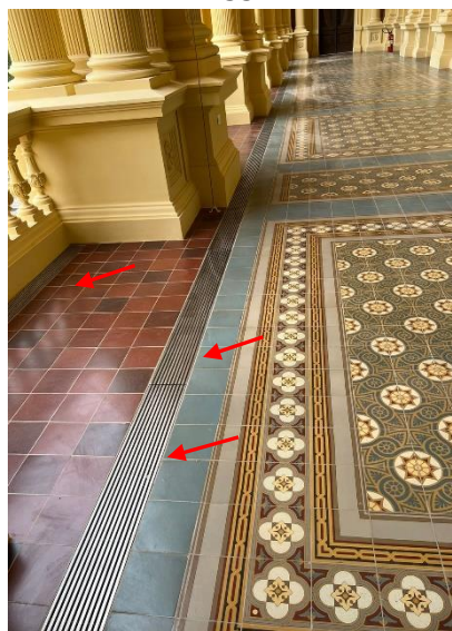
Figura 9 - Canaletas instaladas nas loggias.
