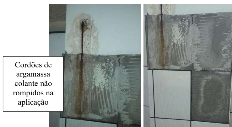
Figura 9. Destacamento do revestimento cerâmico pela presença de umidade proveniente de infiltrações, bem como pela má aplicação do revestimento na etapa de execução.
