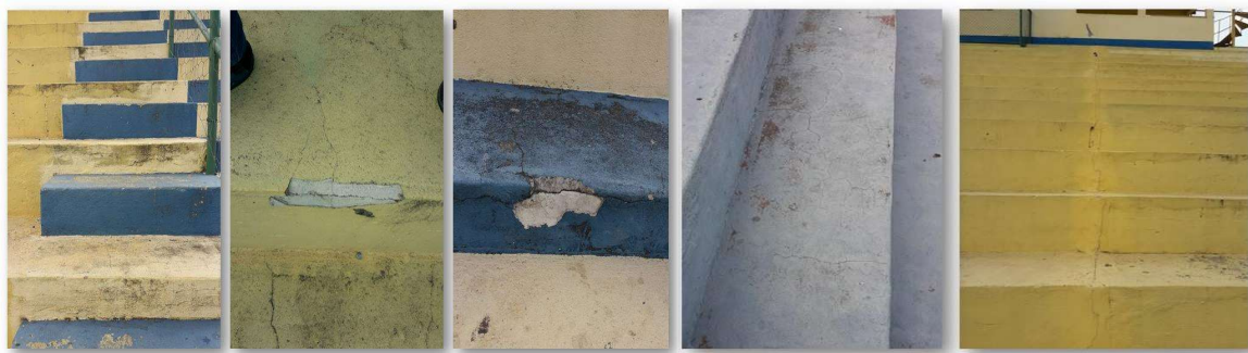
Figura 13. Sujidades, manchamentos e pequenos desprendimentos de argamassa na arquibancada do estádio. Fissuras mapeadas típicas de retração por secagem e juntas estruturais defeituosas ou mau executadas ao longo da arquibancada.
