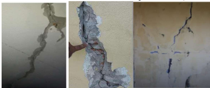
Figura 8. Corredor de entrada dos vestiários. Fissuras com deslocamento de argamassa, rachaduras por conta da corrosão de armadura e fissuras típicas de retração hidráulica.
