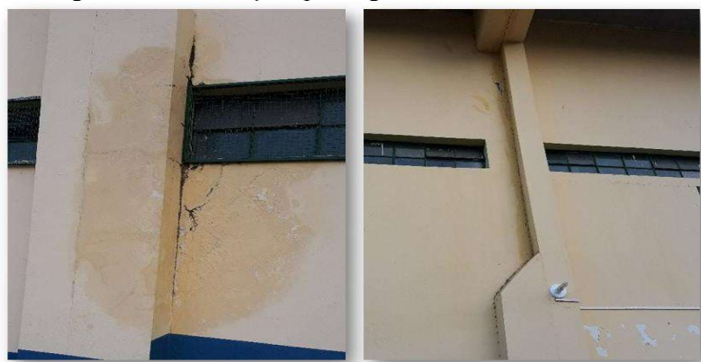
Figura 6. Manifestações patológicas localizadas na fachada.
